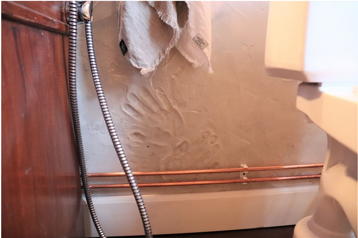
C-talon savirapatussa kylpyhuoneen seinässä näkyi kirjaimellisesti oma kädenjälki. Kuvaaja: Auni Tuovinen.
