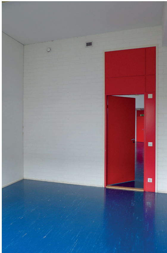
Työhuone, jossa lattiassa on kirkkaan sininen asbestivinyylilaatta.
