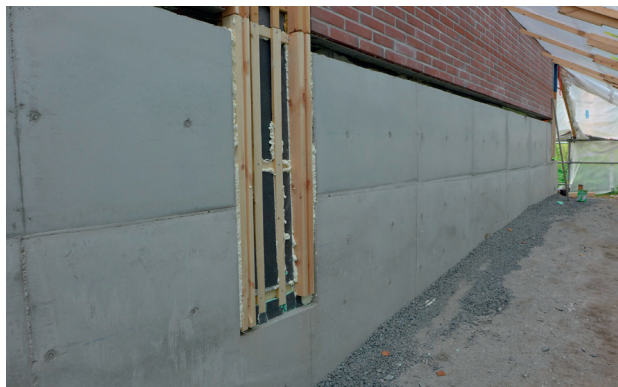
Uusi valettu betonipinta, jossa on alkuperäiseen nähden liikaa muottilaudoituksen pullistumia ja kiinnikkeiden reikiä.
