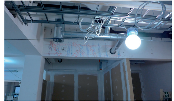
Rakenneskannerilla tutkitut raudoitukset on piirretty palkkiin. Näin läpivienneille sopivat kohdat on pystytty paikantamaan.
