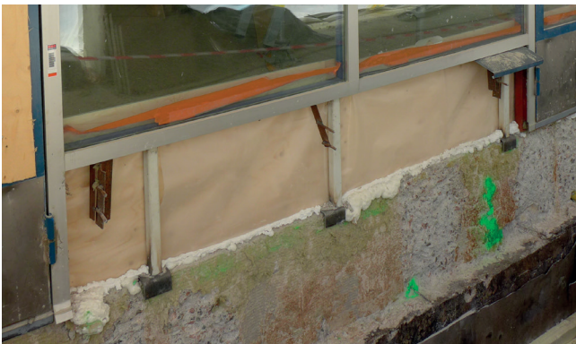
Joidenkin ikkunoiden alapuolinen rakenne purkautui kokonaan sokkelien korjauksen yhteydessä.
