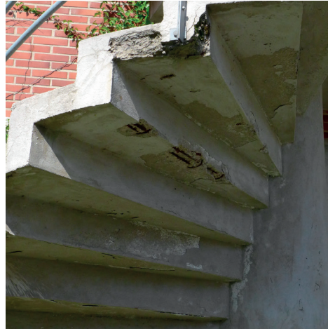
Portaiden askelmissa olevia vaurioita.
