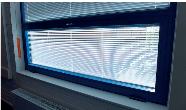
Ikkunan ja sisämuurauksen välinen rako on tässä kohdin niin suuri, että se oli peitettävä listalla (kiinnitys kesken).
