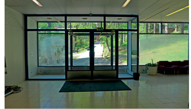
Lounaanpuoleinen sisäänkäynti. Osa ikkunoista on sameita lasielementin vaurioitumisen takia.
