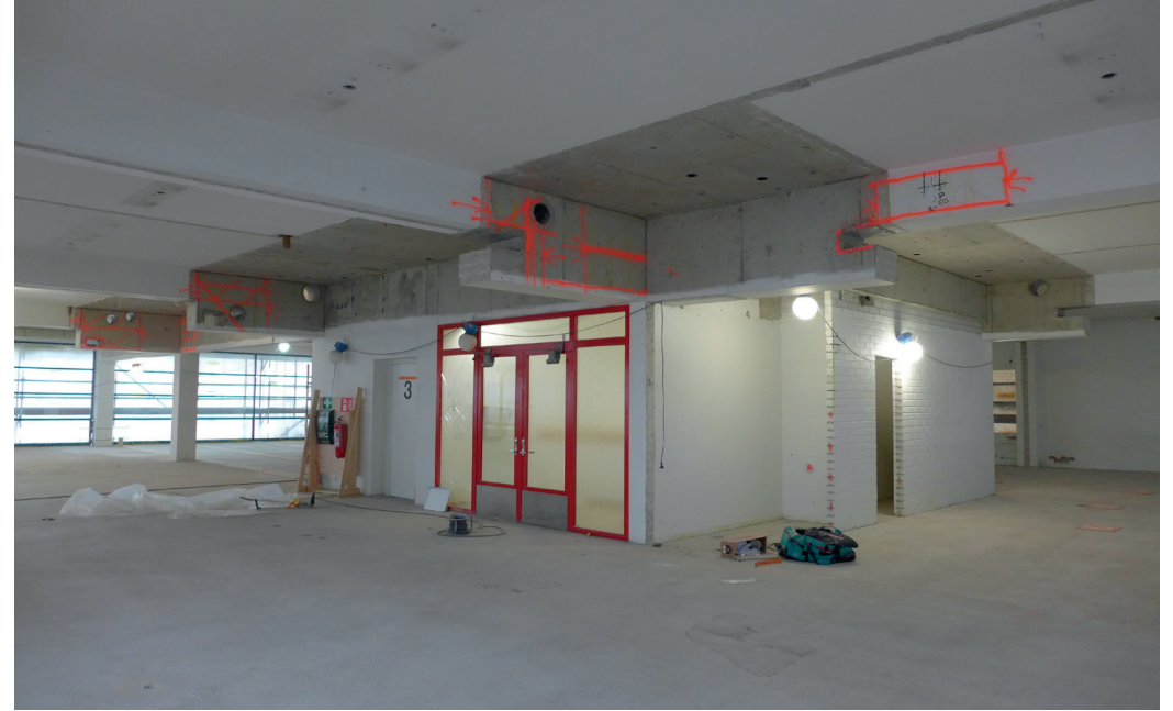
Kolmas kerros seinäpurkujen valmistuttua. Vain rakennuksen keskellä porrashuoneen ympärillä olevat seinät säilytettiin, sillä ne olivat pääasiassa kantavia.
