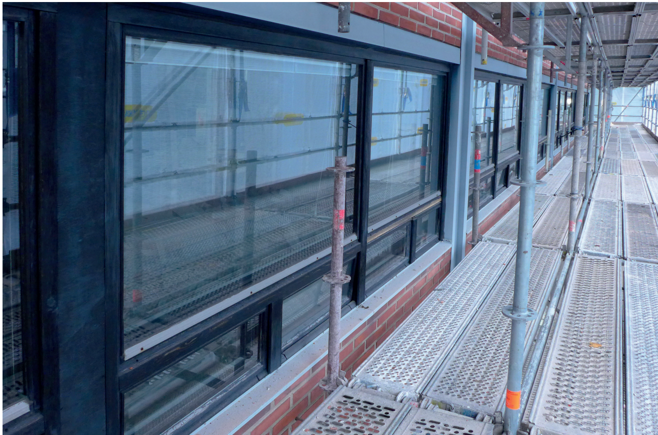
Puiset ulkoikkunat ennen peruskorjauksen alkua. Pintavaurioita lukuun ottamatta ikkunat olivat hyväkuntoiset.
