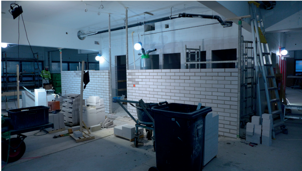
Uuden väliseinän muuraaminen. Sen takana näkyvät wc-tilat, jotka on tehty jakamalla entinen naisten wc pienempiin osiin. Oikealla on vanhalla paikallaan siivouskomero.
