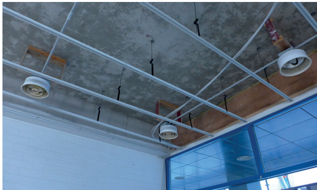
Sisääntuloaulan kattolevyt on purettu ja jäljellä ovat valaisinten lisäksi kattoihin ripustetut hattulistat.
