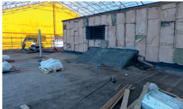
Verhouksen alla oli kuitusementtilevy sekä villaeeriste, jonka paperipinnassa näkyy kosteuden aiheuttamia jälkiä.
