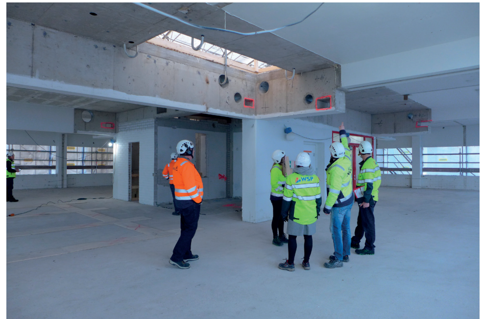
Kolmannessa kerroksessa purkutyöt ovat valmistuneet. Kuvassa keskellä rakennuttajakonsultti Heidi Tiihonen (WSP Finland Oy) ja vastaava työnjohtaja Timo Korpi (NCC Suomi Oy).
