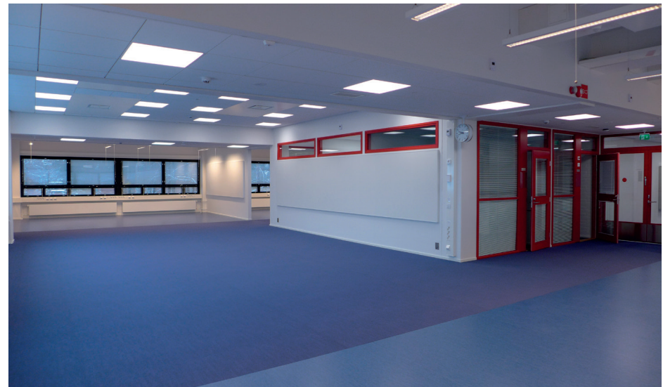
Tila korjauksen jälkeen: tilan keskellä olevaan moduuliruudukkoon on rakennettu pienistä tiloista koostuva alue. Muutoin seiiniä on poistettu ja luotu suuri monitilatoimisto.
