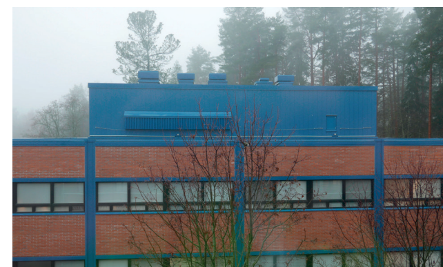
Uusi iv-konehuone kuvattuna Historican ikkunasta. Sivulla näkyvät raitisilmakammion säleikkö ja savunpoistoluukku.
