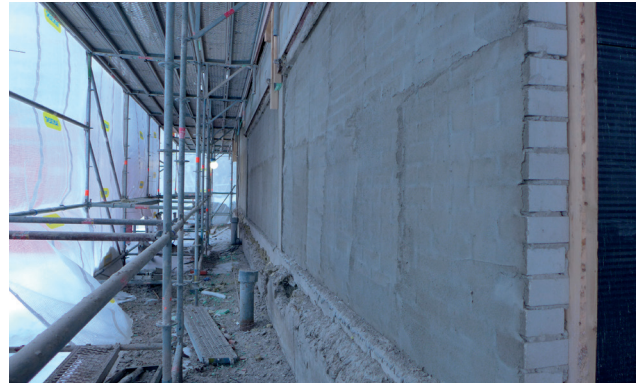
Kaakkoissivulla tiilipintaan on tehty oikaisurappaus.
