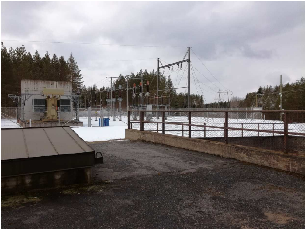
Kuva 4.7: Vesivoimalaitoksen muuntaja ja kantaverkkoon kytkeytyvät voimalinjat.
