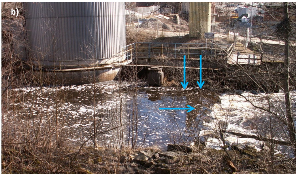
Kuva 2. a) Tourujoen tulvauoma ja pohjapato itärannalta kuvattuna 27.10.2015, jolloin virtaama oli uomassa matala ja puunlehtiä oli kerrostunut mätikorien etupuolelle. Keskiuoman korin kohta on merkitty nuolella. Virran suunta oikealta vasemmalle. Vesivoimala oli käynnissä, joten alasuvannon pinta vasemmalla oli korkealla. Kuva Lauri Rintamäki. b) Tourujoen tulvauoma länsirannalta kuvattuna 15.4.2016, jolloin uomassa kulki ohijuoksuvesiä ja voimala oli käynnissä. Korien kohdat on merkitty nuolilla. Pyöreä rakennus vasemmassa yläkulmassa on Tourujoen vesivoimala.
