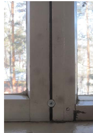
Salin ikkunanpokapari. Vasemmanpuoleinen poka sekä ruuvikiinnitys on tehty vuonna 1981. Oikeanpuoleinen poka on alkuperäinen.
