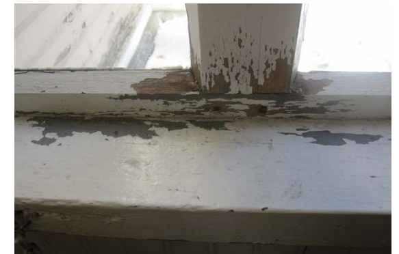
Kuistin ikkunassa pintamaalin alta näkyy tumma siniharmaa sävy.
