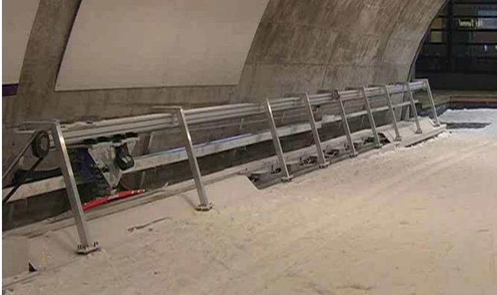
KUVA 24. Suksenliikutuslaite Vuokatin hiihtoputkessa
