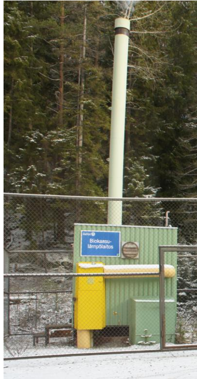
Kuva 5. Kaatopaikkakaasua energianlähteenä käyttävä aluelämpölaite Keltinmäessä Jyväskylässä. Kaasu ohjataan kaukolämpöä tuottavalle laitokselle läheiseltä Mustankorkean kaatopaikalta.
