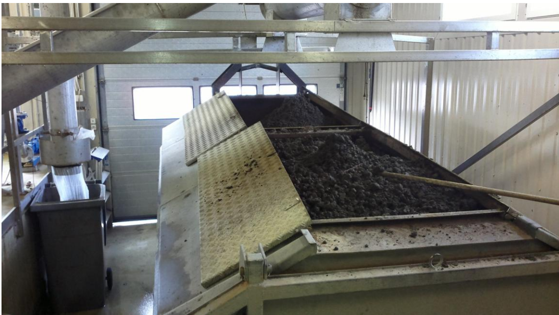
Kuva 10. Vaihtolava, johon liete ohjataan kuivauksen jälkeen odottamaan kompostointia.
