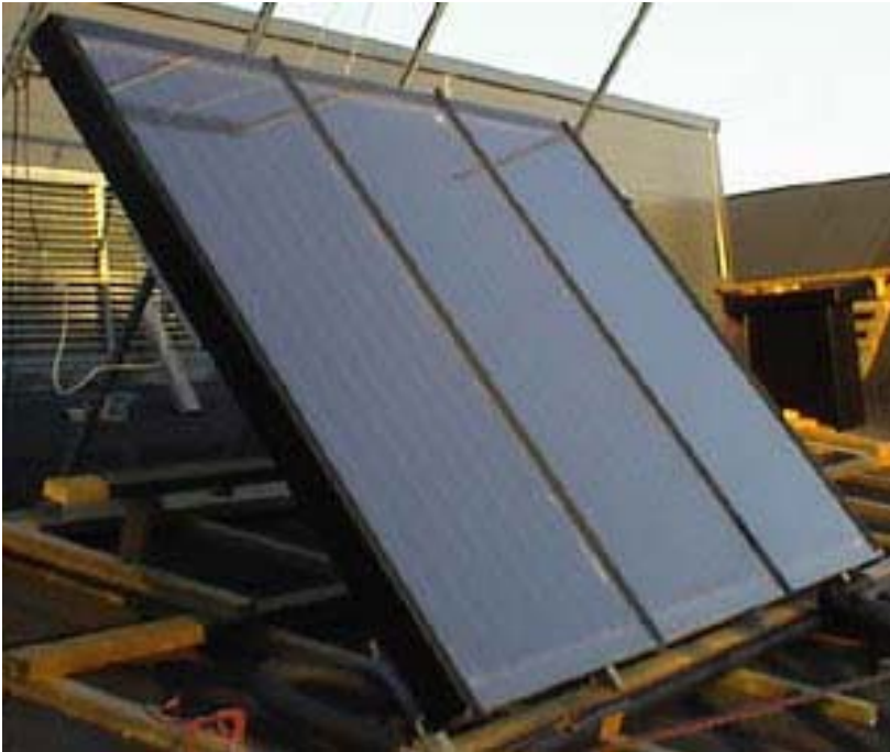
Kuva 2.26 Tasokeräin TX 2009 käyttöveden lämmittämiseen.
