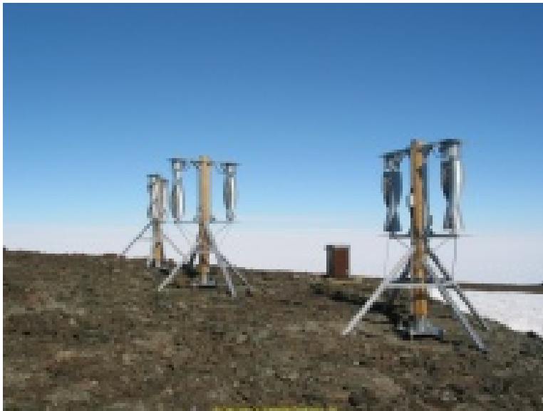
Kuva 2.22 Kuusi WS-0,30A turbiinia Aboa-tutkimusasemalla Etelämantereella.
