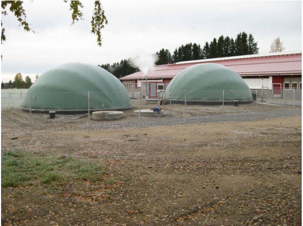
Kuva 2.18 Maaningan tutkimuspihaton biokaasulaitos. 300 m 3 biokaasureaktori ja 300 m 3 jälkikaasuallas. Syötteenä lietelanta ja kasvibiomassa. Jatkuva kaasuteho noin 100 kW.
