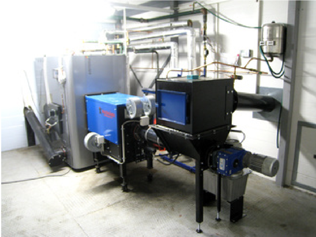
Kuva 4.3 Ariterm 150 kW BioComp –kattila varustettuna automaattinuohouksella konvektio-osassa.
