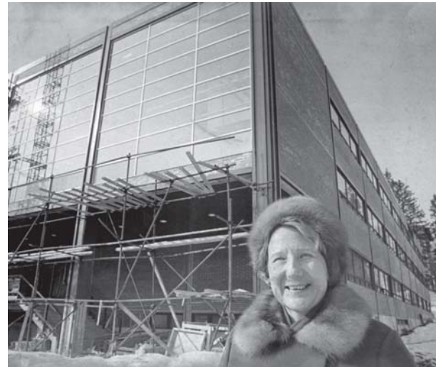
Ylikirjastonhoitaja Eeva-Maija Tammekann katselee maaliskuussa 1974 tyytyväisenä, miten Arto Sipisen piirtämä uusi kirjaston päärakennus kuoriutuu rakennustelineistään. Hän oli tässä virassa 1965-1980. Valok. Matti Salmi. Jyväskylän yliopiston museo.
