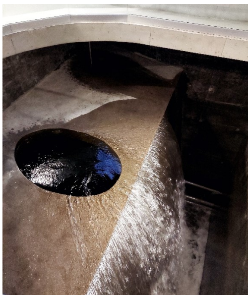
Kuva 18. MBR-permeaatin purkukaivo, Mipu.
