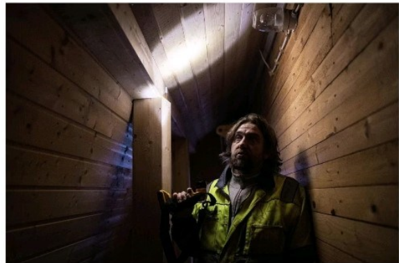
Palonen käy kurkkaamassa yläkerran sivuvinttiä. Lappeiden eristäminen vesikatont vasten voi tyypillisesti aiheuttaa ongelmia.
