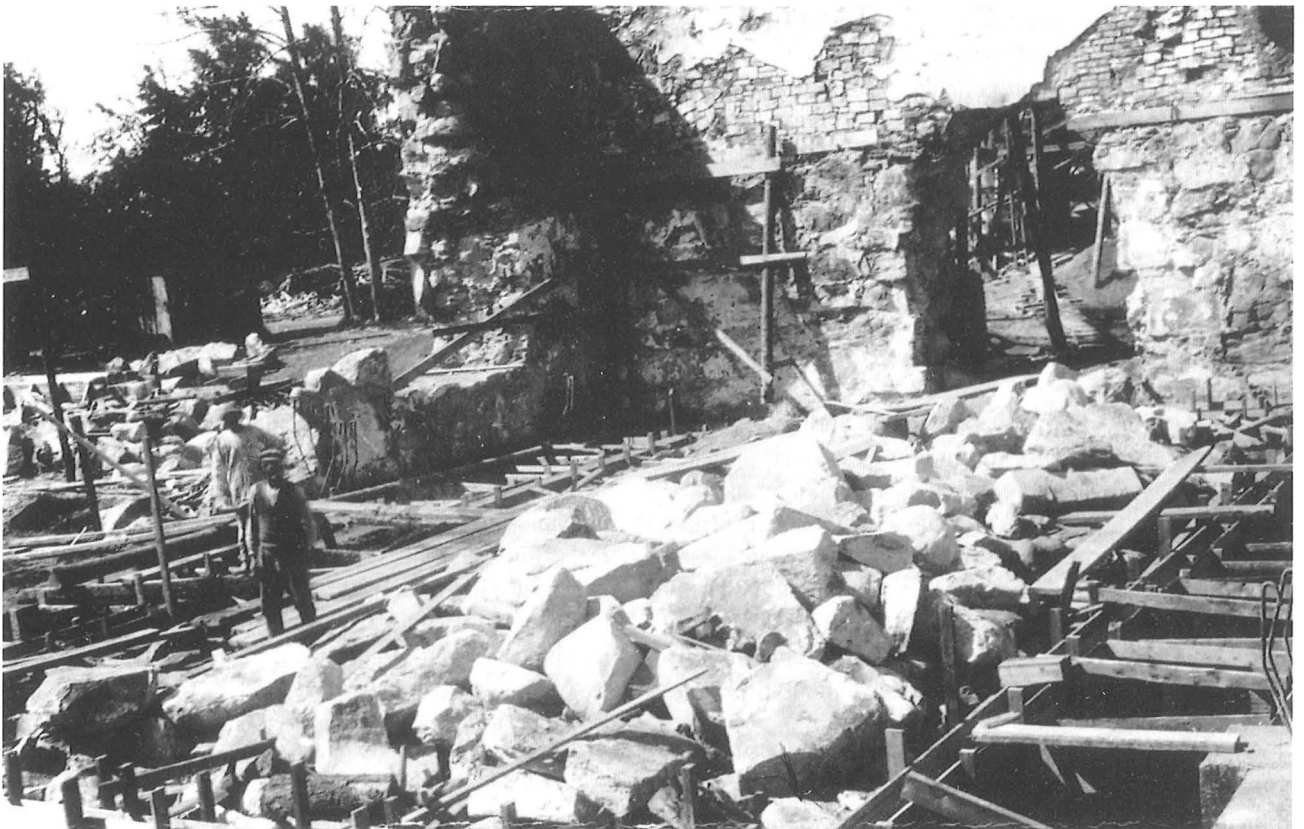
1. Sääksmäen kirkon rakennustyömaa 1.7.1932. 1800-luvulla rakennetut sivusakarit on purettu ja vanhasta kirkosta ovat jäljellä vain päädyt ja pätkä sivuseiniä.
