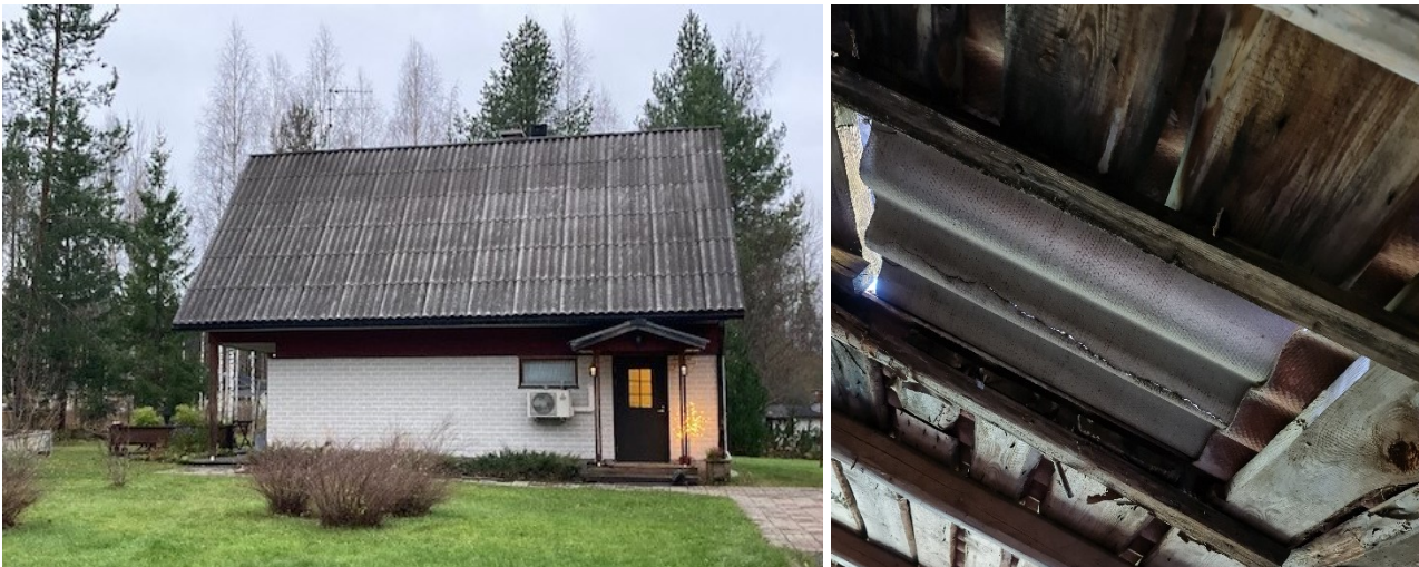
Kuvat 6, 7. Asbestipitoisia kattolevyjä (KRJ).
