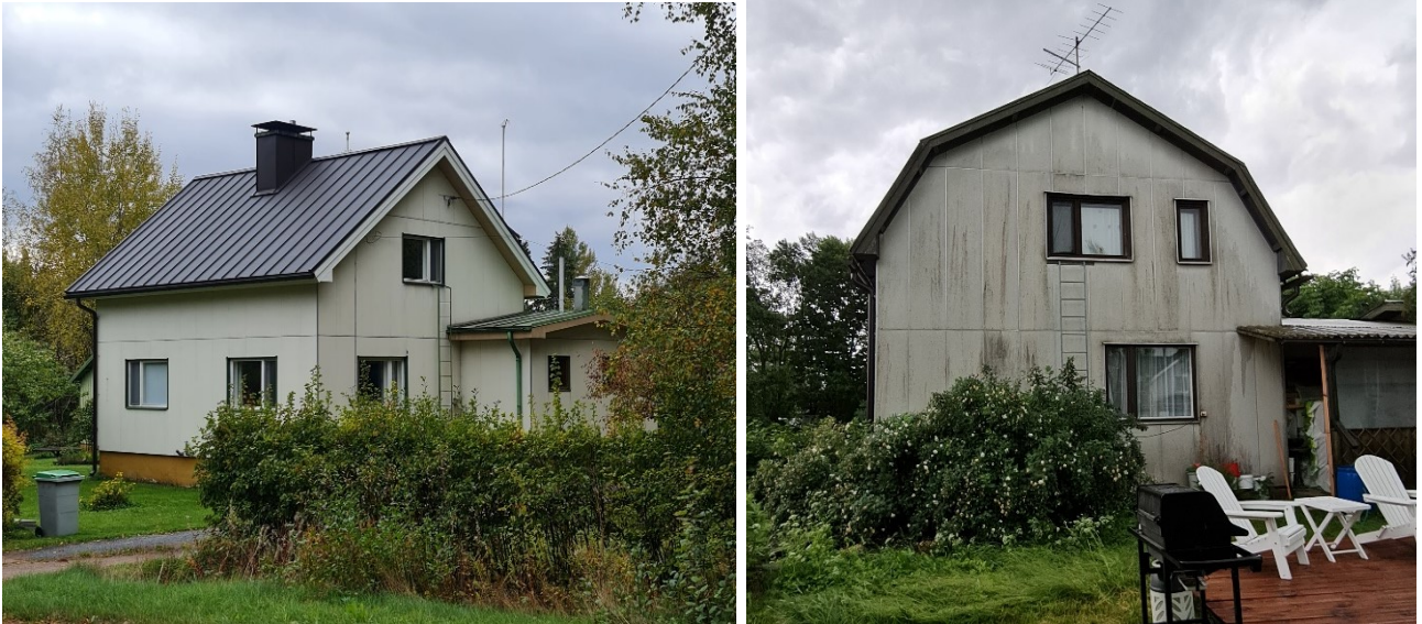
Kuvat 14, 15. Myöhemmin lisättyjä julkisivulevyjä (KRJ)
