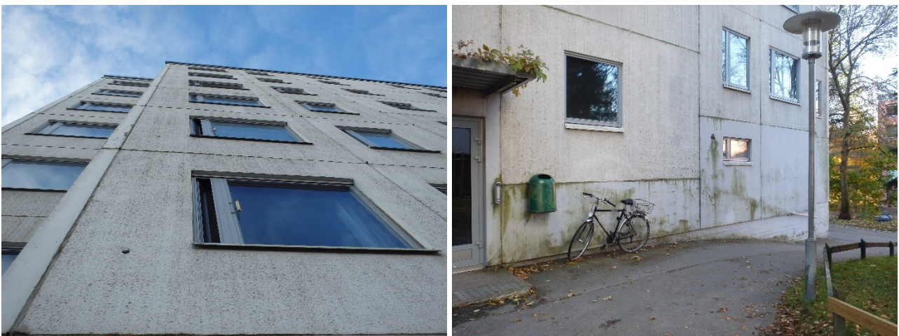
Kuvat 8, 9. Vuonna 1972 valmistuneen kerrostalon ruutuelementtien maali on asbestipitoista (KRJ).
