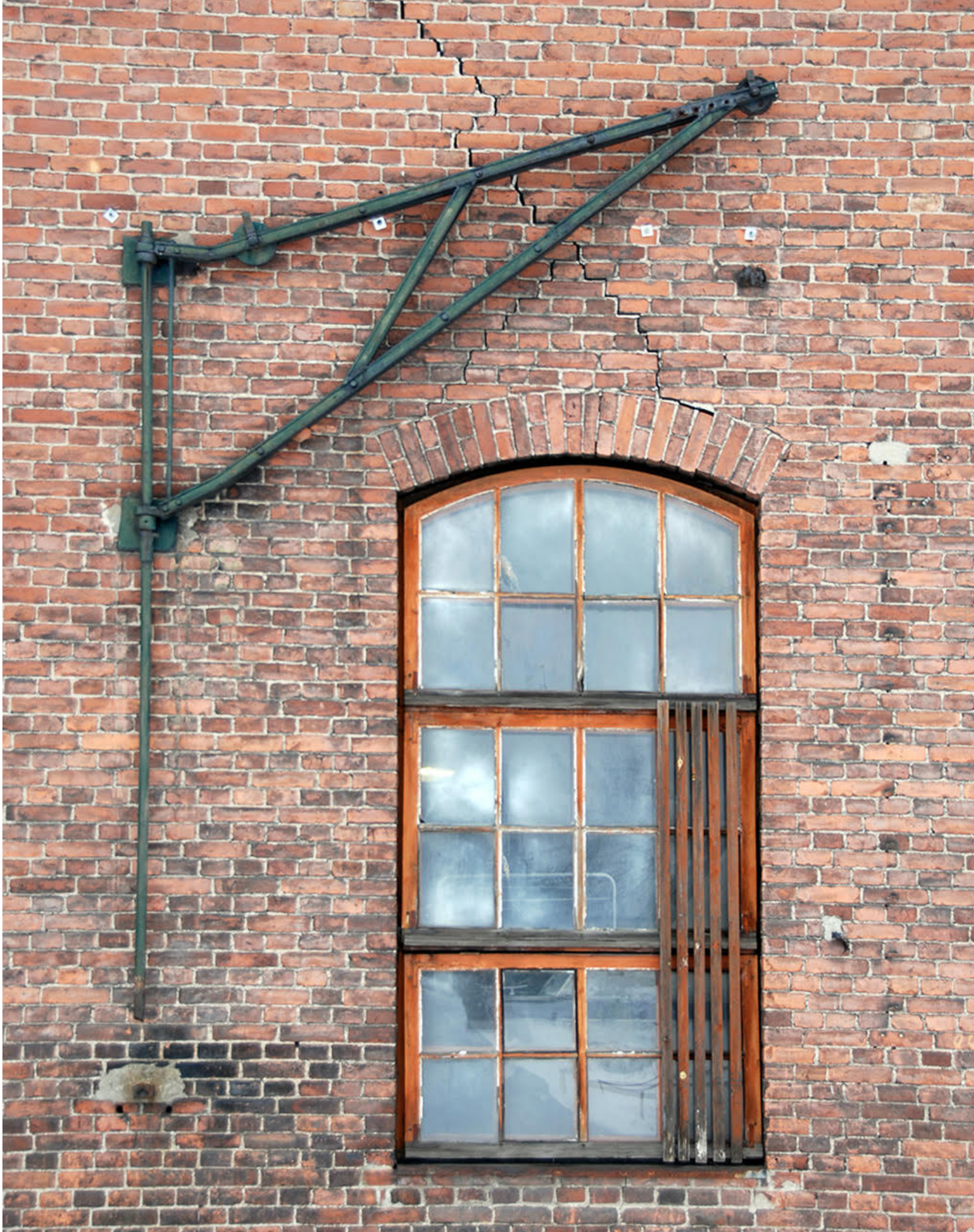
Jussi Jäppinen (2006) vanhimman päädyn ulkoseinän halkeama ja seinään kiinnitetty kevytnosturi.
