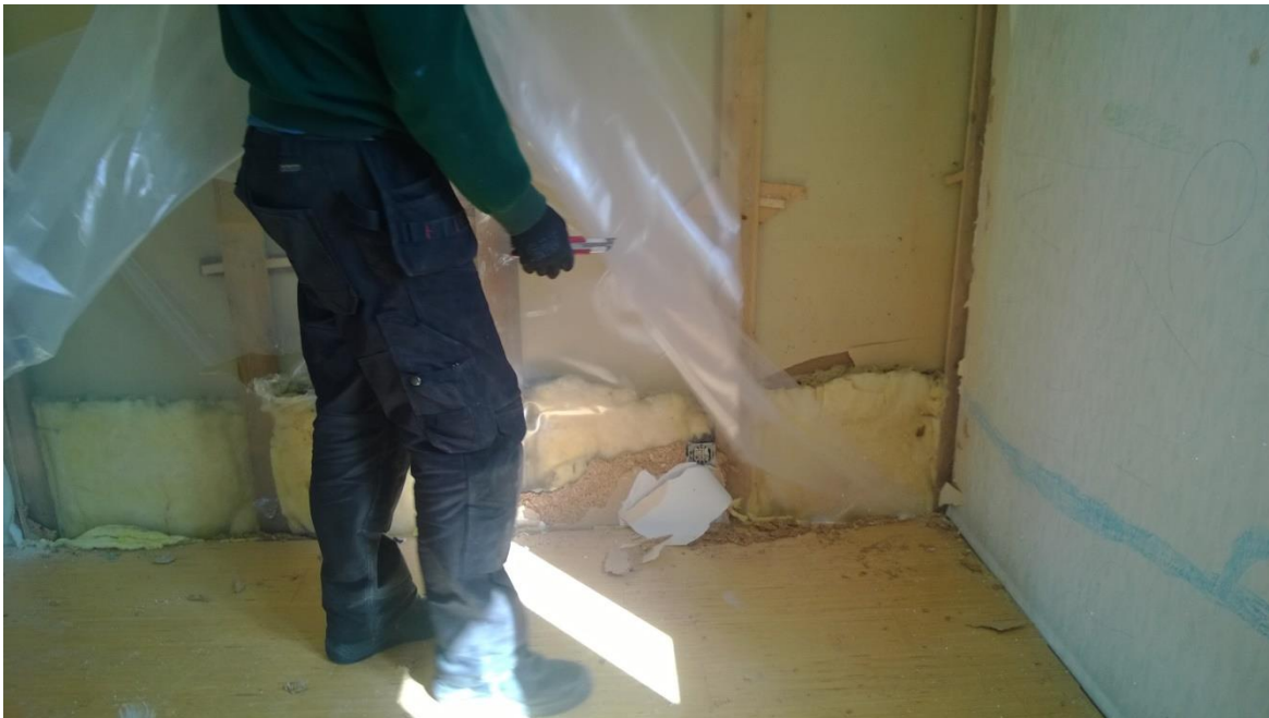
Kuva 17 Mitä paljastuu seinästä lastulevyn takaa? Muovi, ja muovin takana seinän alareunasta vuorivillaa tukittuna vetoa estämään. Kuva: Pohjalaistalo 1:n valokuva-albumi.
