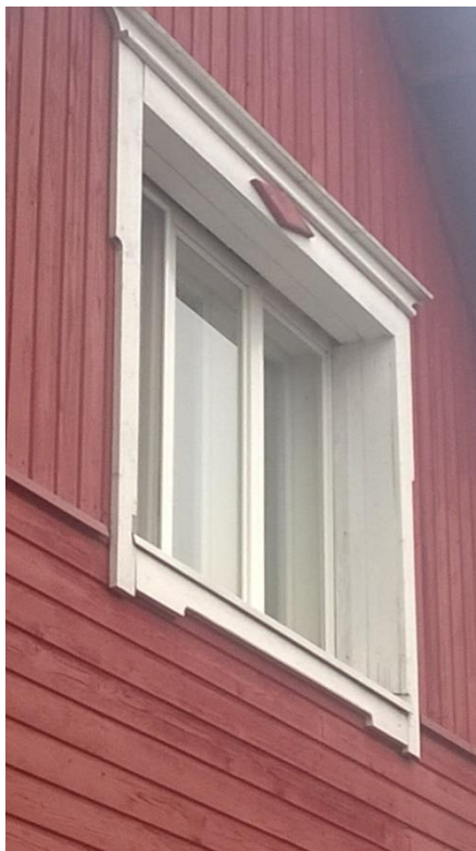
Kuva 15 Ikkunat syväällä seinässä tuplaeristämisen seurauksena. Kuva: Pohjalaistalo 1:n valokuva- albumi.
