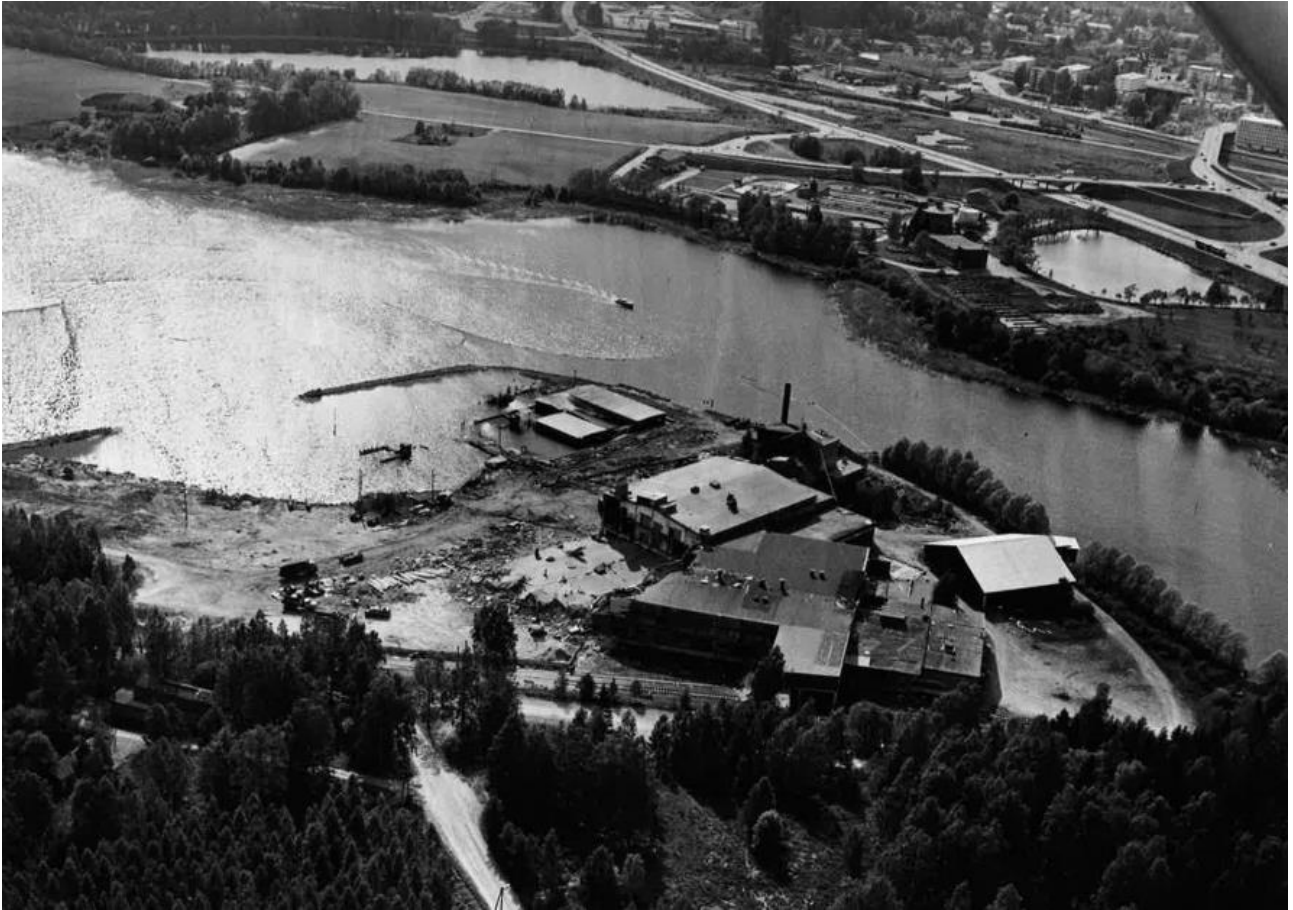
Teollisuusrakennusten purkutyöt käynnissä kesällä 1989. Taustalla osia Mikkelin kaupunkikeskustasta ja kaupungin ohitustielinjaus. Kuva: Länsi-Savon valokuva-arkisto/ Teuvo Karjalainen.
