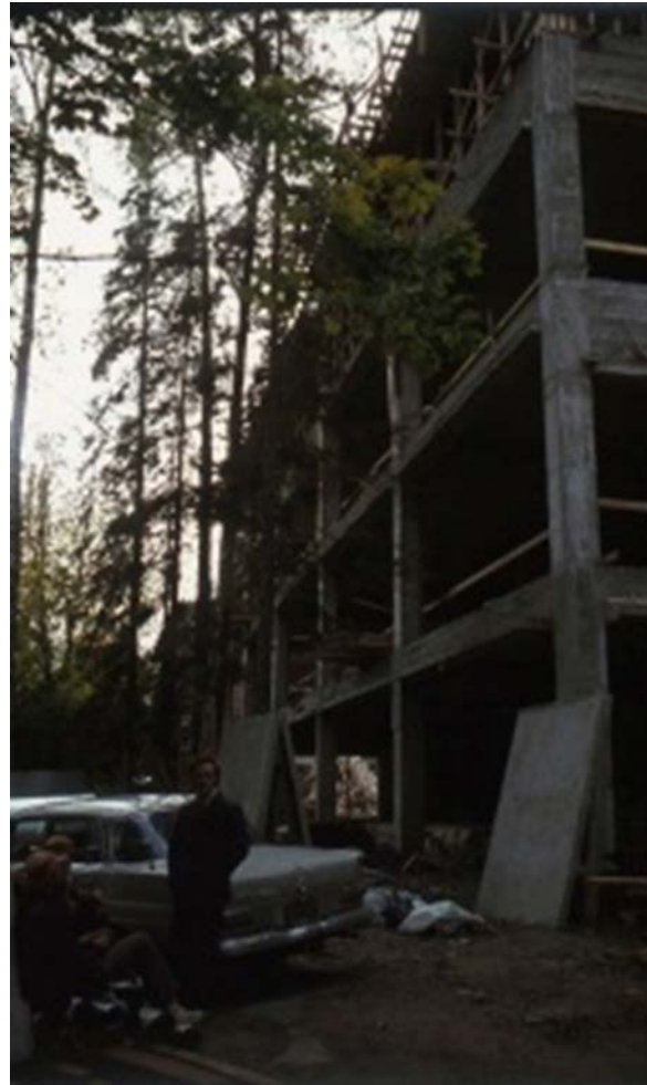
Hallinnon työmaan runkovaihe on valmistunut. Kuvassa näkyy hyvin rakennuksessa käytetty paikallaan valettu pilari-palkkirunko.
