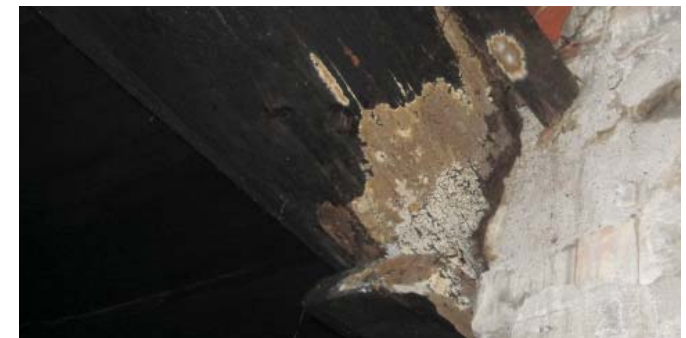
Vaurioita piipun vieressä hirressä. Kuva: Piritta Ernvall 2013 JYM.
