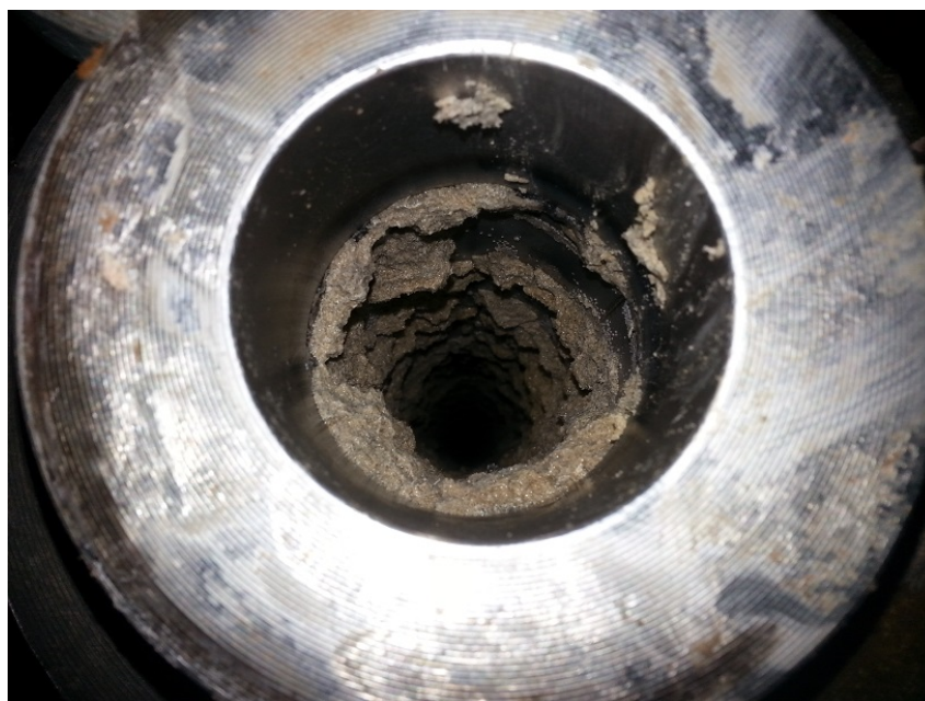
Kuva 8. Saostumaa keittoliuosputken sisäpinnalla. Kuva otettiin 4. keittimeen menevästä putkesta pesun yhteydessä 8.4.2016.
