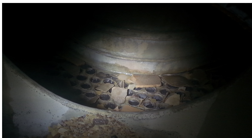
Kuva 6. Haihdutinyksikön 6 tuubilevyllä paisuntaosan seinämiltä pudonnutta kivettymää. Kuvattu kevätseisokin yhteydessä 25.4.2016.
