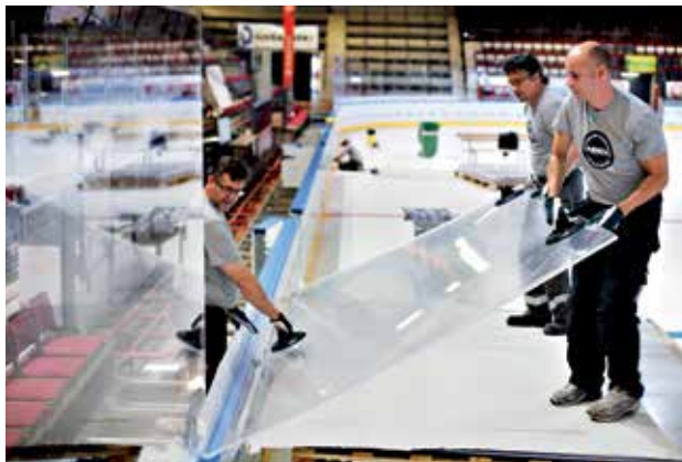
Vesa Karjalainen (vas.), Mauri Koskela ja Heikki Hanski Raita Sport Oy:sta asensivat Hipposhallin joustokaukaloa heinäkuussa.
