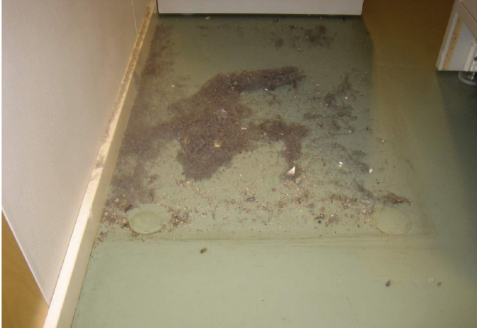
KUVA 13. Kaapin alla olevaa pölyä ja likaa (valokuva E. Honkala 2007).
