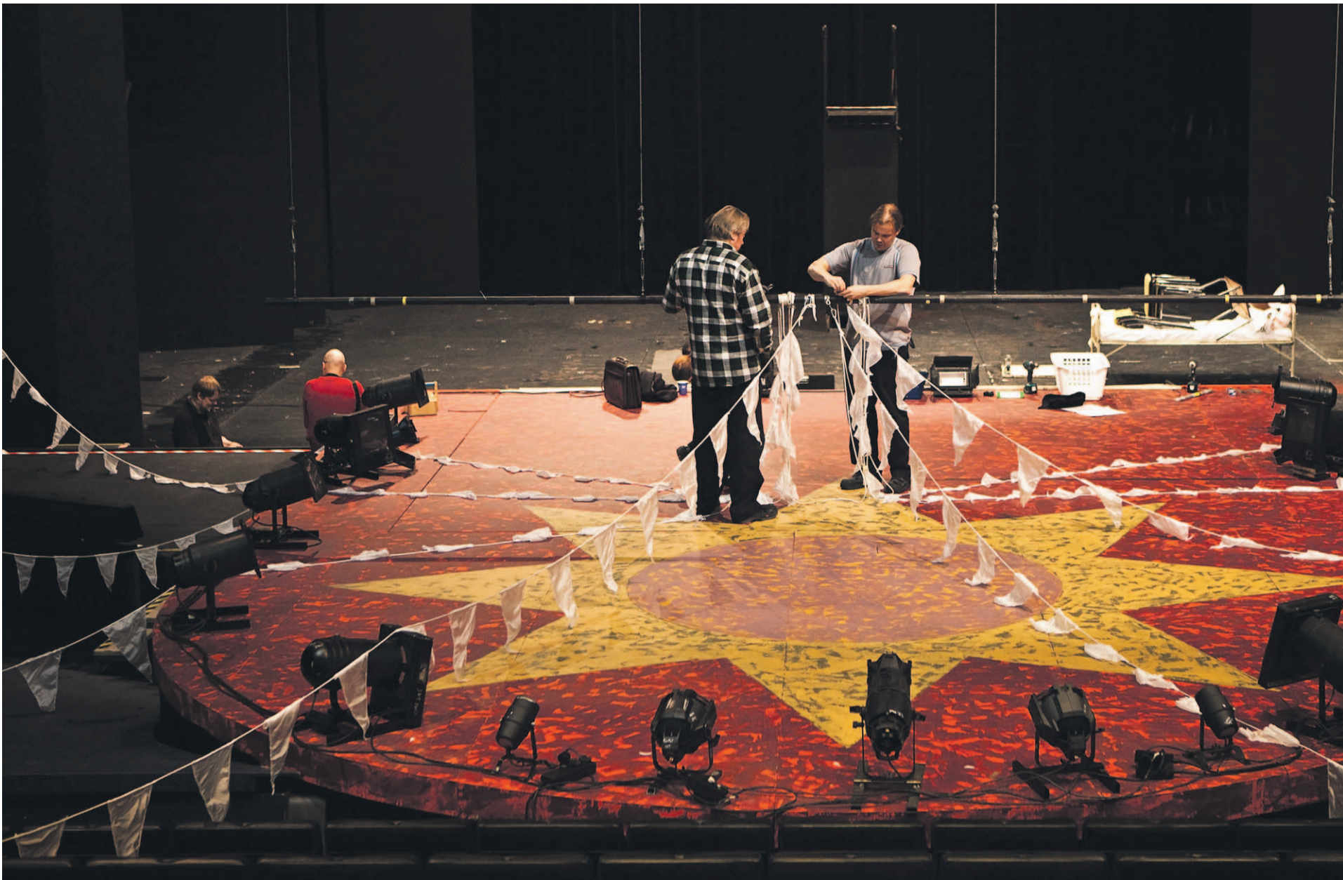
Maaria Blomman lavasterakennelma on poikkeuksellinen, sillä se ulottuu muutaman penkkirivin verran katsomon puolelle. Lavasteet joudutaan purkamaan paikaltaan jokaisen näytelmän jälkeen. Näyttämömies Antero Lahtisella ja näyttämöestari Pasi Leinosella riittää töitä myös ensi-illan jälkeen.
