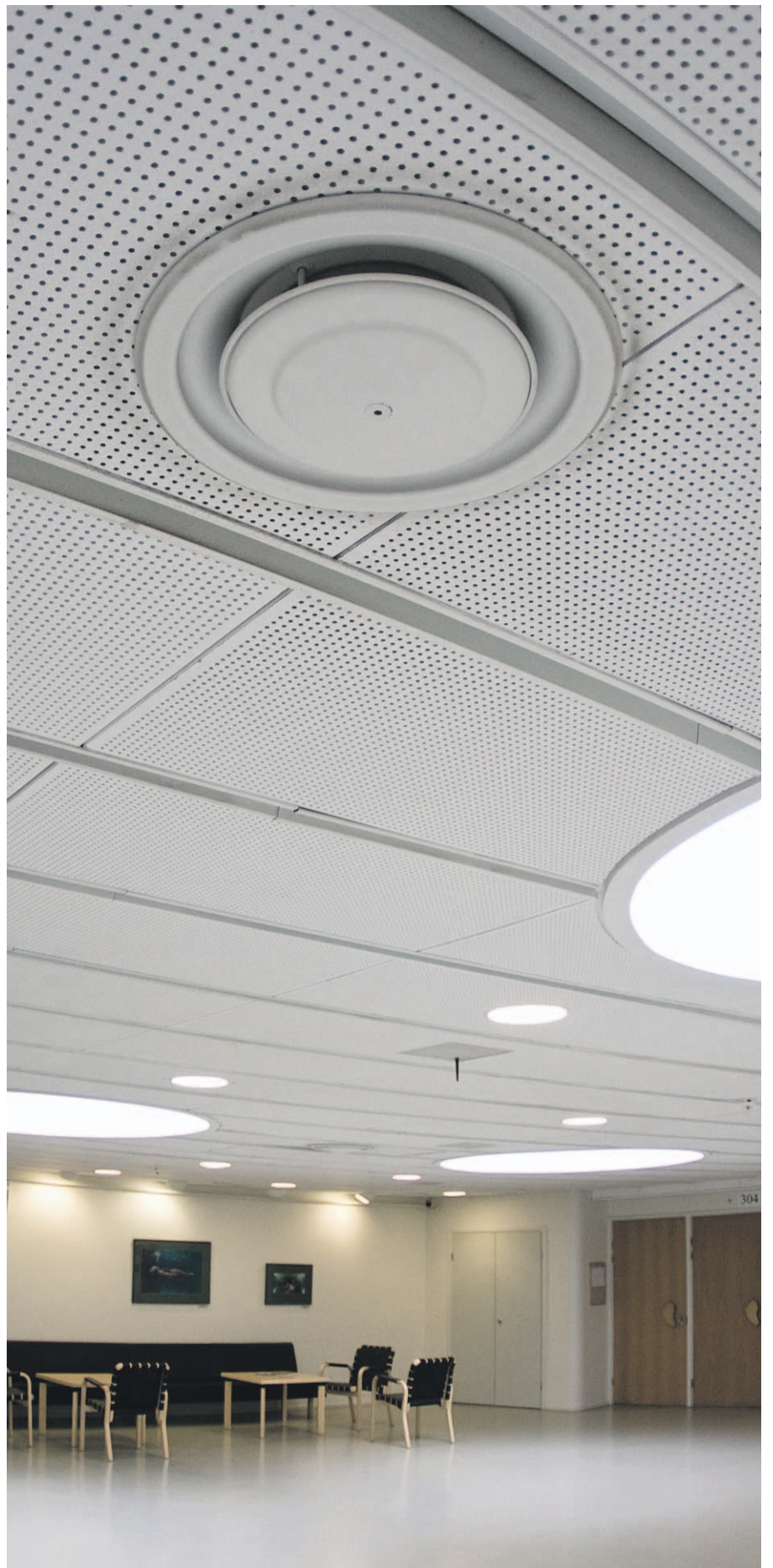
L-rakennuksen ilmanvaihto on alimitoitettu.
