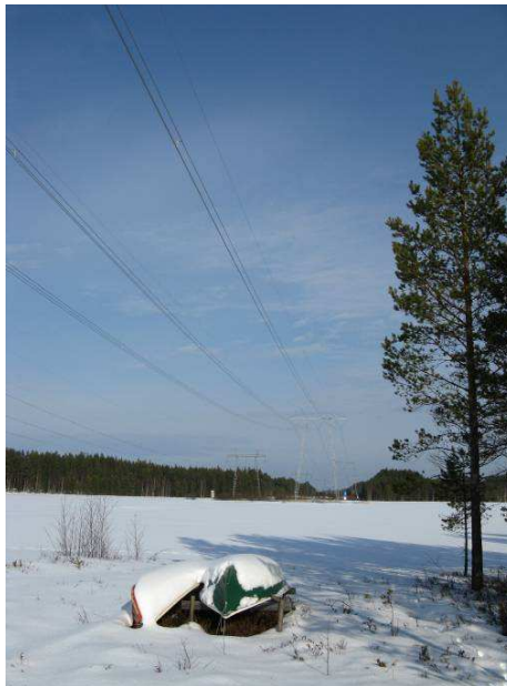
Kuva 5. Uusi 400 kV:n voimajohto vanhan 220 kV:n voimajohdon rinnalla Jämsänkoskella.
