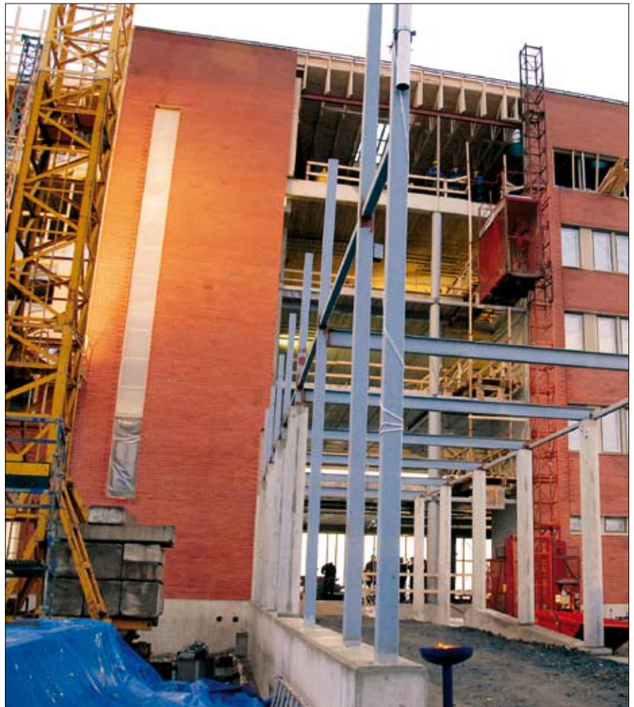
Rakennukselle leimaa antava pitkä sisäntulokatos on jo näkyvässä. Katos ohjaa vierailijan suoraan pääovelle ja sitä kautta pääaulaan.
