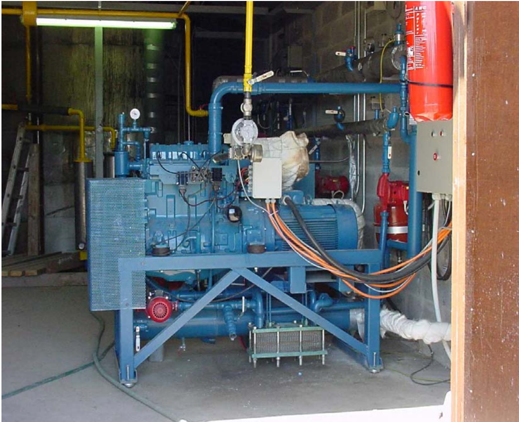
Kuva 2.4. Maatilakohtainen sähkön ( 30 \text{ kW}_e ) ja lämmön ( 60 \text{ kW}_t ) yhteistuotantolaitos Kalmarin tilalla Laukaassa. Mikro-CHP-laitteena on biokaasukäyttöinen Sisun ottomoottori, joka on muunnos traktorikäyttöön Valtralle valmistettavasta dieselmoottorista. Biokaasureaktori näkyy taustalla (Lampinen 2004b). [Jeremias Kalmari 2002]
