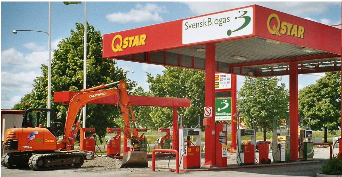
Kuva 8.10. Norrköpingissä Ruotsissa lisätään uusia polttoainesäiliöitä huoltoasemalle, jonka biopolttoainevalikoimaan kuuluvat paikallisesti tuotetut biojäte-CBG100, rypsi-B100 ja vilja-E85. Fossiilisista polttoaineista autoilijoille tarjotaan lähes aromaattisista yhdisteistä vapaata alkylaattibensiiniä, E5-bensiiniä ja B2-dieselöljyä. [2005]
