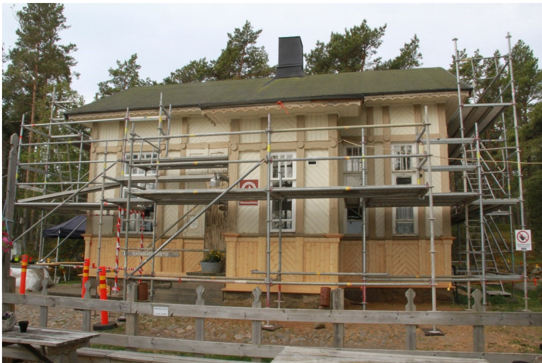
Kuva 47 Santarmintalon korjaushanke, kuva työmaavaiheesta, uusi porras asennettu ja rakennuksen alaosaan tehty kunnostuksia (kuva Hilja Palviainen 2022)
