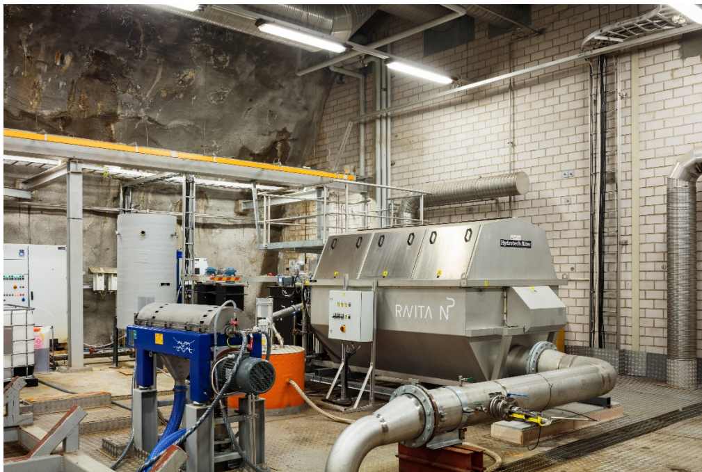
FIGURE 7. RAVITA™ pilot plant for P precipitation (HSY/Tuomas Uusiheimo)
