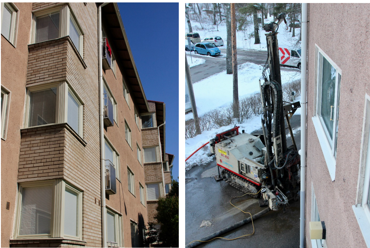
Maalämpöön siirtynyt taloyhtiö Lönegropen Helsingin Herttoniemessä. Kuvat: Simo Kyllönen.
