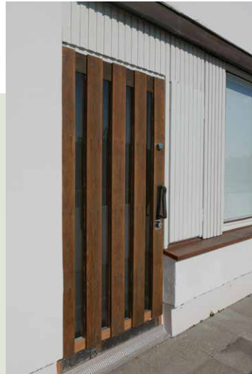
Oven vaurioituneita puuosia oli oven alaosassa uusittava.
