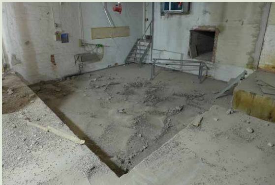
Toisen kerroksen konehuoneen lattian syvennys. Lattiamaalista löydettiin lyijyä.
