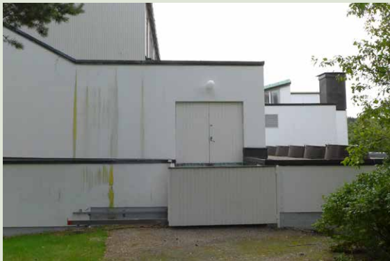
Vanhan osan lastauslaituri. Portin takana oleva porraskiskokorotus on leikattu sivuun.
