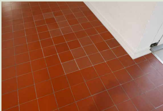
Latomalla uusia ja vanhoja laattoja sekaisin ei synny selkeästi erottuvia korjausalueita.
