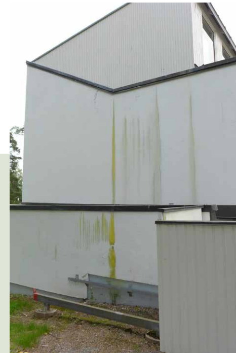
Rakennuksen länsisivulla julkisivun maalipinnassa olevia värjäymiä.
