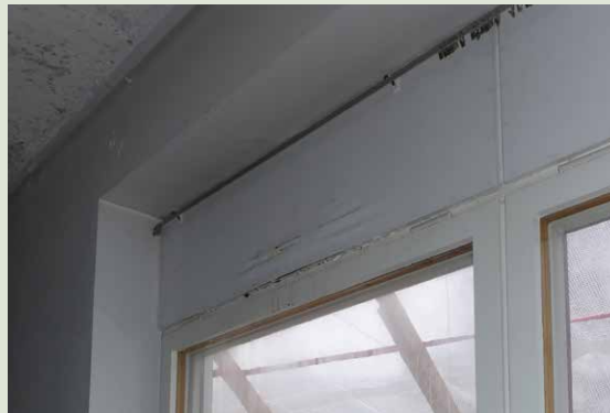
Kimpilevy ikkunan yläpuolella on turvonnut kosteudesta. Myös katossa on nähtävillä kosteusvaurioita.
