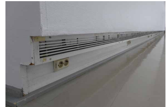
Ilmastointiseinän alaosassa oli kolmiportainen. Alimpana sähköjen johtokouru ja keskellä ilmastointisäleikkö.
