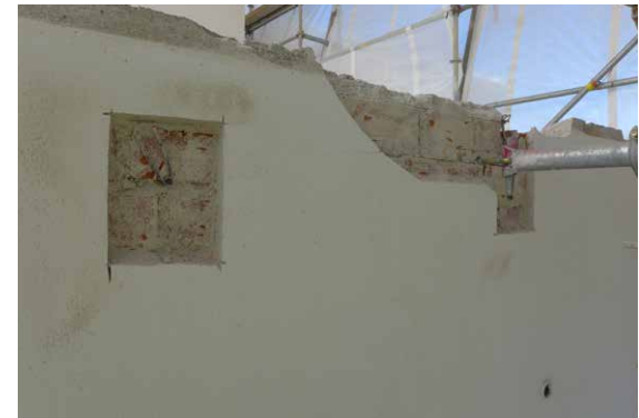
Puuosien kiinnitykseen käytettyjä sidelankoja ja nauhoja on tullut esiin vaurioituneen rappauksen alta.
