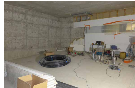
Tilasta on purettu kiinteä kalustus, lattiapinnoite, lasikettu alakatto ja osa seinien pintamateriaaleista.
