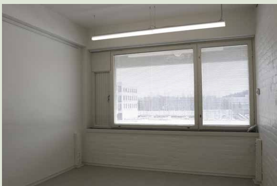
Ikkunan yläpuolella ollut tuloilmasäleikkö on poistunut ja korvautunut koneellisella ilmastoinnilla.
