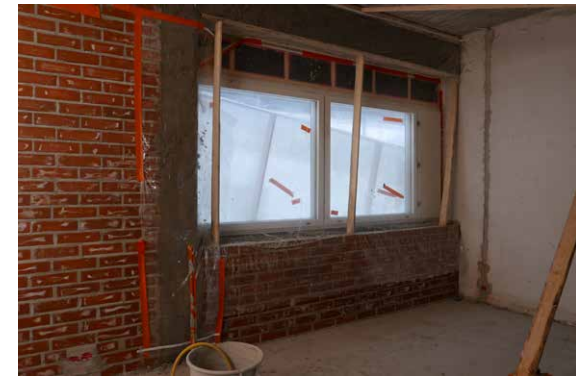
Ikkunan ja sen ympäröivän alueen korjaukset. Palkki ja pilari on tasoitettu uuden tiilimuurauksen tasoon.
