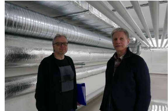
Ilmanvaihtokonehuoneen tekniikkakäytävän ideoinnista diplomi-insinööri Timo Holopainen (vasemmalla) ja toteutettuun ratkaisuun erittäin tyytyväinen tilaajan edustaja, energia-asiantuntija Tero Hirvelä.
