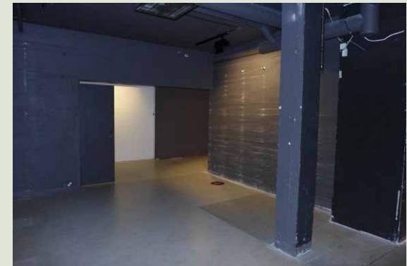
Tilassa 203B mustan kotelon sisällä olevat sadevesiviemärit olivat vuotaneet lattialle.
