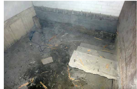
Varaston 209 betonilaatan ja muottilaudoitusten alta paljastuneet betoniset porrasaskelmat.
