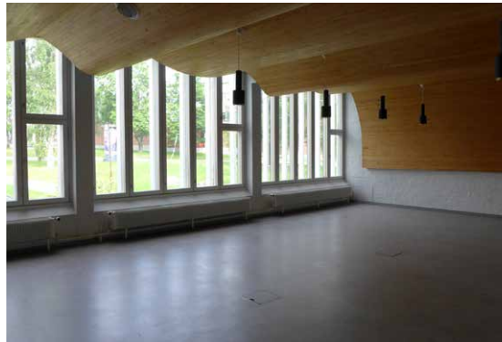
Kuva ennen korjauksia salin takaosaa ja ikkunaseinää kohden. Aaltoileva katto laskeutuu takaseinälle.
