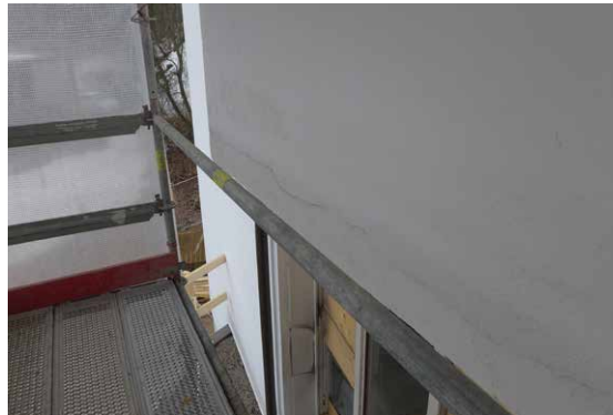
Sisäänvedon kohdalla oli rappauksessa pitkä halkeama, jota oli yritetty korjata useita kertoja.
