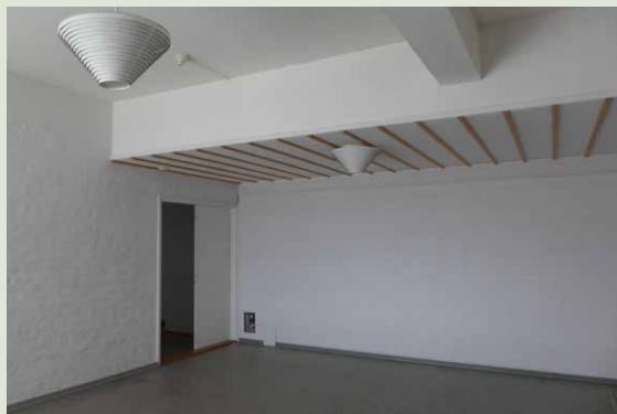
Huoneessa 212 oleva laskettu alakatto puulistoineen ennen korjausta.
