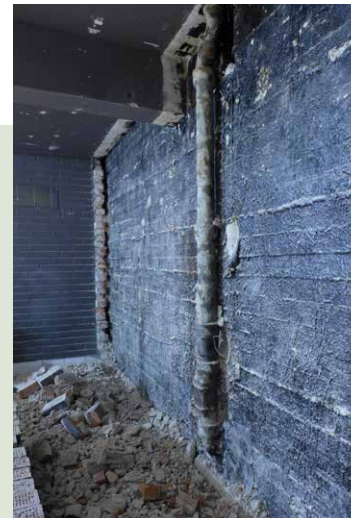
Tilassa 203 seinän muurauksen sisällä ollut sadevesiviemäri.
