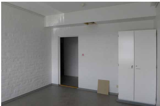
Huone 210 ennen korjausta. Huoneessa 211 kotelointu asennusreitti kulki myös kaapin ja seinän välissä.
