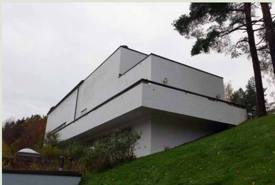
Hilseilevää maalipintaa rakennuksen kaakkoisseinällä sekä parveke, joka kiertää rakennuksen kahvilaa.
