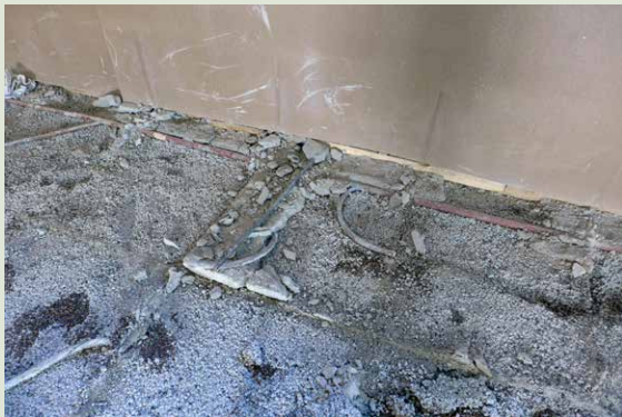
Tilan 301 välipohjan kevytsorabetonieristettä ja sen päällä olevia lattialämmitysputkia.
