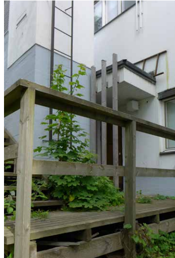
Puinen tasanne ja siitä ylös nousevat puuportaavat rakennuksen lounaanpuoleisessa rinteessä.
