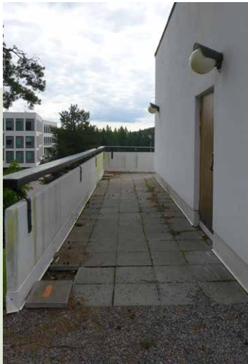
Kolmannen kerroksen tasossa oleva parveke ennen korjauksia.
