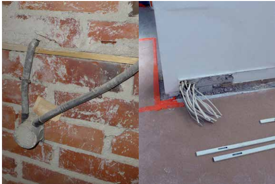
Alkuperäisiä ja myöhemmin tehtyjä sähköasennuksia näyttelysalissa 401.
