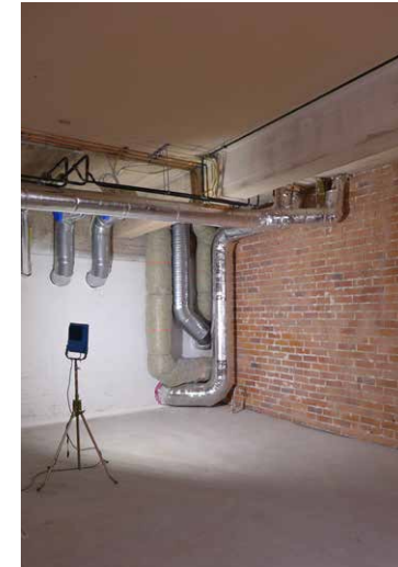
Seinän toiselle puolelle rakennetusta iv-kanaalista tulevat tekniikka-asennukset huoneen nurkassa.
