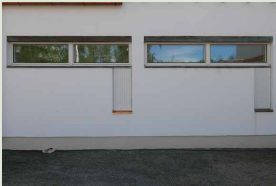
Vanhat vesipellit on suoristettu ja puhdistettu. Toisen tuuletusluukun vaurioitunut pelti on korvattu uudella.
