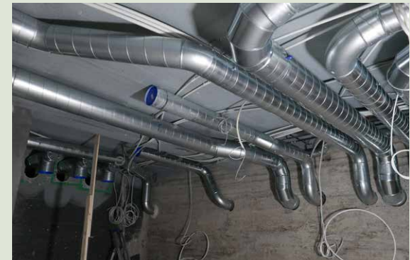
Ilmastointikanavien reitit kulkevat opetustilan kautta. Asennukset tulevat jäämään alakaton yläpuolelle.
