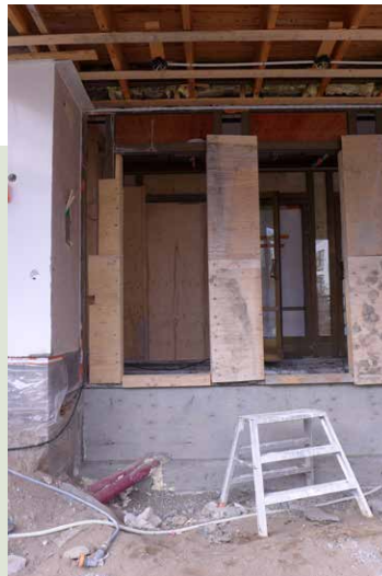
Kivilaatoitus on poistettu ja alapuoliset kerrokset purettu. Ovien kohdalle on valettu uusi antura.
