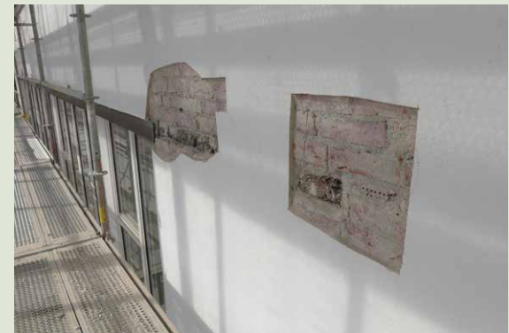
Saapasalkin korkkieriste jatkuu rappauksen alla. Ikkunaa oli pienennetty rakennustöiden aikana.
