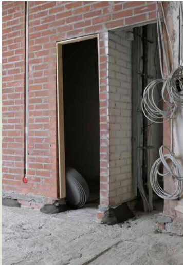
Uudelleen muurattuja väliseiniä ja epätasainen vanha alalattia.
