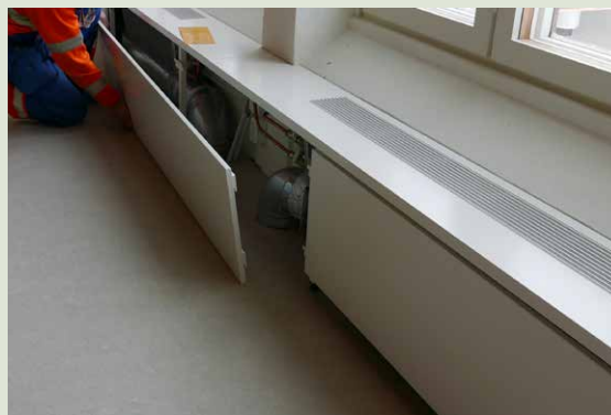
Suutinkonvektorien suojapenkin on huomioitu huolto sekä sopivuus tilan ilmeeseen.
