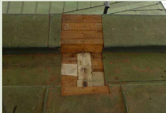
Asbestinauhaa kuparin alla toimistosiiiven katossa.
