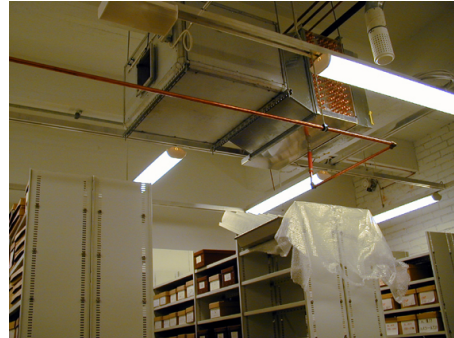
KUVA 29 Kattoon kiinnitetty arkiston kosteuden- ja lämmönsäätöön tarkoitettu laite vuotaa vettä, ja siksi ei käytössä. Alla olevat hyllyt kuitenkin ovat tyhjinä ja muovilla peitetyt
