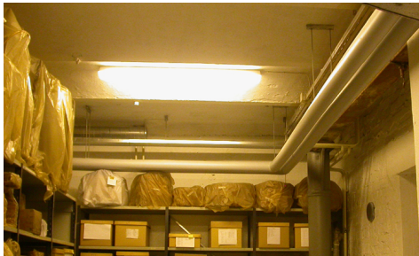
KUVA 30 Vesi- ja viemäriputkia, lämmitysvesiputkia arkistotiloissa
