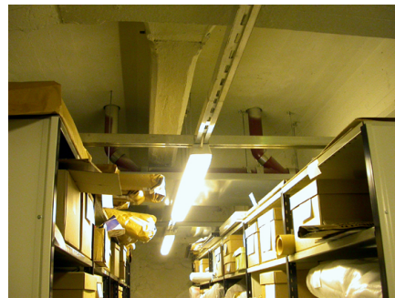
KUVA 31 Katossa olevat peltikourut suojaavat osittain kokoelmia vesivahingon sattuessa vieden vettä viemäriin.
