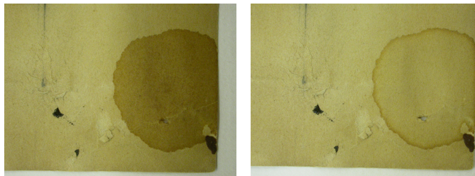
KUVAT 14–15 Pintaelektrodimittauksen jättämä kosteusjälki, märkänä ja kuivana.
