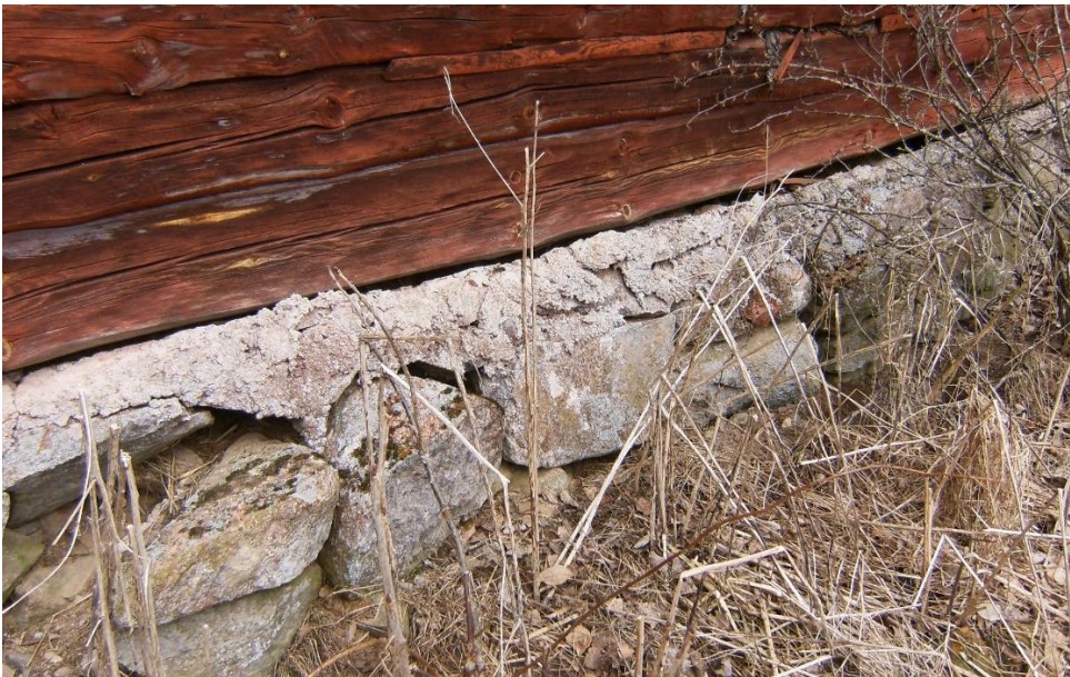
Kuva 27: Luonnonkivistä ladottu kivijalka. Kivijalka on myöhemmin betonoitu, mutta betoni on lähes kokonaan rapissut pois.
