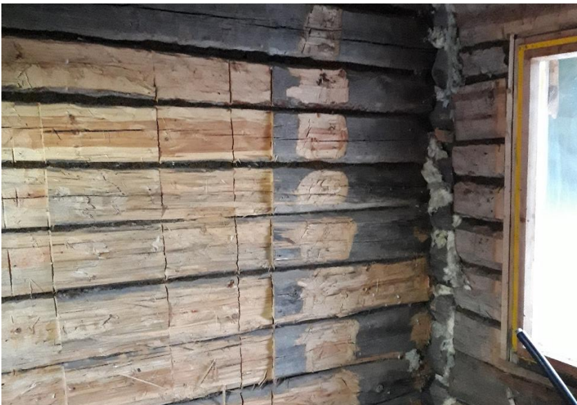
Kuva 25: Ala-Vahterin eteisvälikön seinä joulukuussa 2018. Harmaantunut hirsiseinä on joskus ollut rakennuksen ulkoseinä. Nurkassa näkyy hirsiseinän jatkos. Hirsiiä on veistetty tasaisemmiksi levytyksen yhteydessä. Levyt on purettu kesällä 2018.
