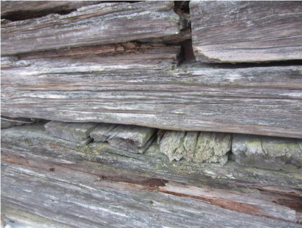
Kuva 21 Luuvan lattialaudat työntyvät hirsirakenteen kolmannen hirsikerran varauksesta rakennuksen seinätasoon
