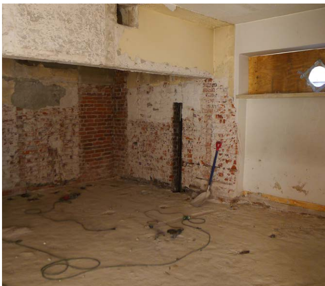
Sosiaalityötilojen väliseinäpurut ovat päättyneet. Seinältä löydettiin vanha tiiliseinään toteutettu pystykanava. Toinen myöhemmin lisätty hormi on ollut tilan nurkassa.
