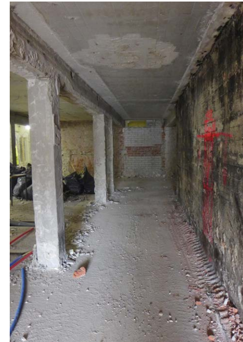
Keittiön tilajaossa on tapahtunut vuosien varrella suuria muutoksia. Alkuperäinen, ulko-ovelta alkanut pitkä käytävä, jonka varrella oli mm. varastotiloja, tuli jälleen hetken ajaksi esiin väliseinäpurkujen jälkeen. Peruskorjauksessa tila jaettiin osaksi leipomoa, keittiötä ja astianpesutilaa.
