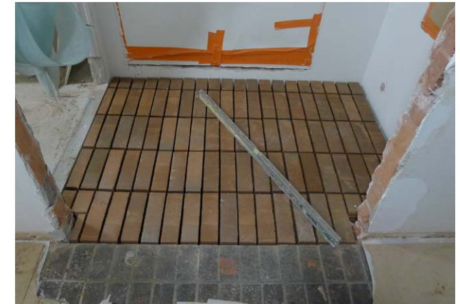
Inva-WC:n eteistilassa jatkettiin votsiin limitettyä tiililattiaa uusilla tiilillä. Syvennyksen edustalla näkyy, kuinka paljon tiilet ovat tummuneet vahakerroksien ja niihin imeytyneen lian vaikutuksesta.
