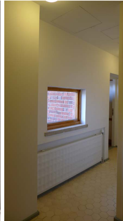
Käytävä peruskorjauksen jälkeen. Alkuperäinen radiatori on palautettu kunnostettuna syvennykseen ja ikkunapenkki on kaventunut.
