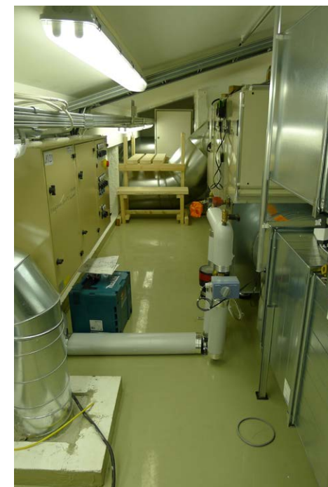
Viistokattoinen matala tila on täytetty ilmanvaihtolaitteilla. Lattiasa on uusi pinnoite.
