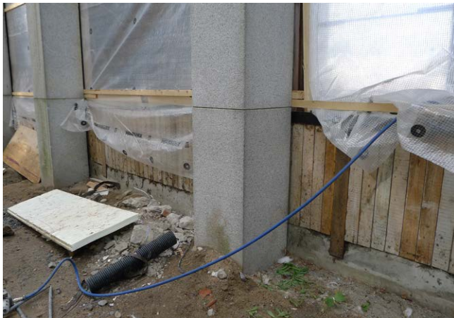
Kupariverhouksen alla ollutta laudoitusta.
