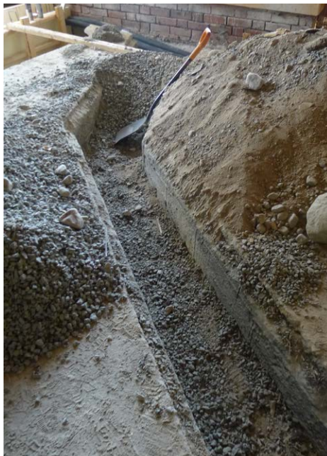
Lattiasta löytynyt vanha asennuskanaali.
