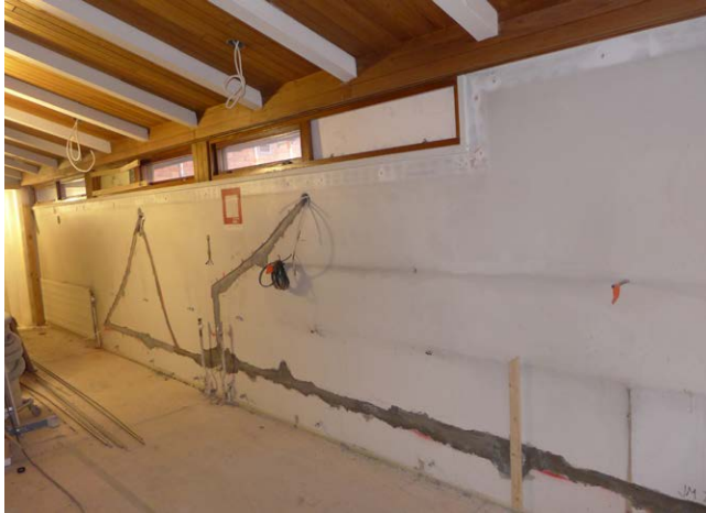
Johtoja varten seinän rappausta roilottiin, sillä pinta-asennuksia ei tiloihin haluttu. Ikkunoiden alta on poistettu muovinen sähkökouru.
