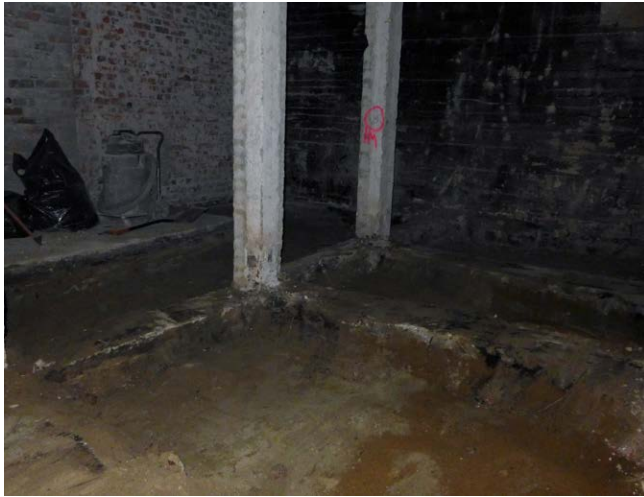
Alapohjan purkutyöt ja maakaivuutyöt alkavat valmistua. Pilareiden välissä kulkee pääosin ilman muuttia valettuja sidospalkkeja.
