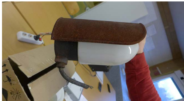
Vanha huonokuntoinen ulkovalaisin kerhohuoneen ulko-oven vierestä. Valaisinten ikä ei ole tiedossa.
