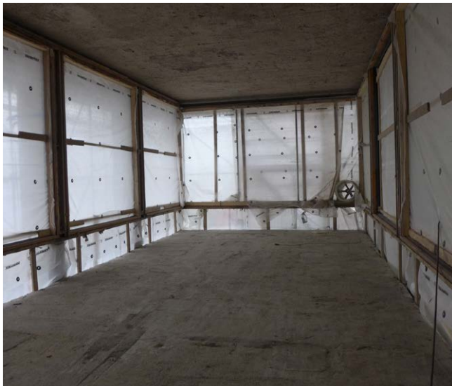
Lyhty purkutöiden loppuvaiheessa. Tämän jälkeen irrotettiin vielä karmit ja purettiin vielä seinien puurungon rakenteita.
