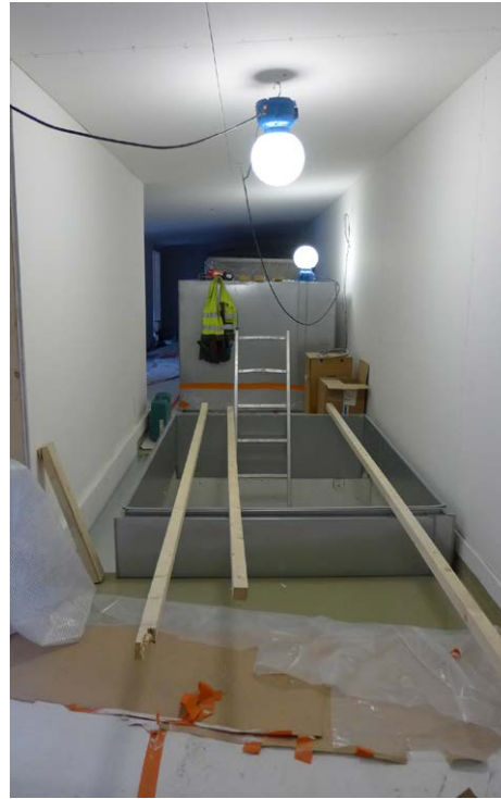
Ilmanvaihtokonehuone ja aukko ilmakanaaliin.
