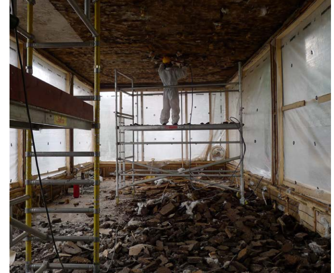
Ekspandoitu korkkilevyeriste oli kiinnitetty betonipintaan bitumilla tai liimalla. Materiaalissa oli mikroibivaurioita.
