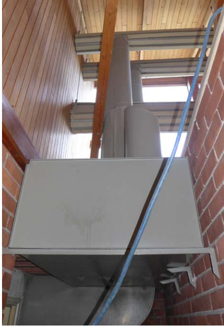
Ruokasalin vanhat IV-asennukset seinäkkeen takana ennen peruskorjausta.
