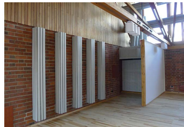
Ruokasalin ilmastointilaitteita peruskorjauksen jälkeen. Seinällä entistetyt IV-kanavat jäivät pois käytöstä. Siirretyn seinäkkeen takana tuloilmasäleiköt ja niiden yläpuolella kattoon kohoavat kunnostetut poistoilmapiiput.
