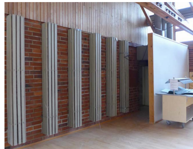
Ilmanvaihdon päätelaitteet ja osan ilmanvaihtolaitteista peittävä seinäke ruokasalin takaosassa ennen peruskorjausta.
