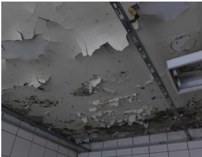
Astianpesutilan kosteus oli aiheuttanut alakaton yläpuolella betonirakenteiden kostumisen mikä näkyy mm. maalipinnan hilseilynä.
