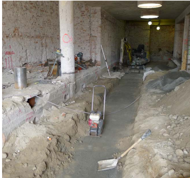
Käytävän maanpohjan tasoitus. Kuvassa myös huoltotunnelin yläosa, johon sahattiin paljon uusia läpivientejä talotekniikalle.
