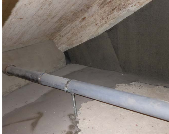
Portaiden alla umpiotilan pinnat on puhdistettu, lattiaa tasoitettuja uusia vedeneristeitä asennettu tilaan.
