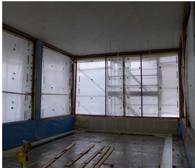
Uusia rakenteita tekeillä: katossa levytys, lattialla epoksikäsittely ja vesiputkien kourut, seinille teipataan höyrynsulkumuovia.
