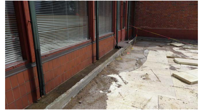
Terassin vanha betoninen räystäskouru ja seinien laatoitukset. Betonilaatat ja asennushiekat on poistettu, alla oli suodatinkangas ja lämmöneristeet.
