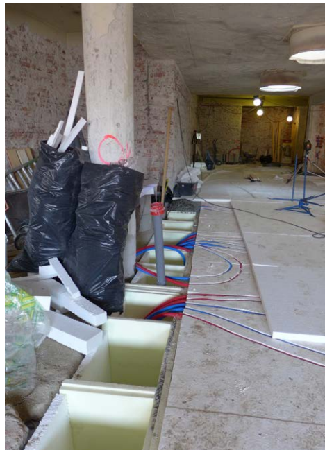
Huoltotunnelista tulevat käyttövesiputket on sijoitettu alempaan lämmöneristekerrokseen.
