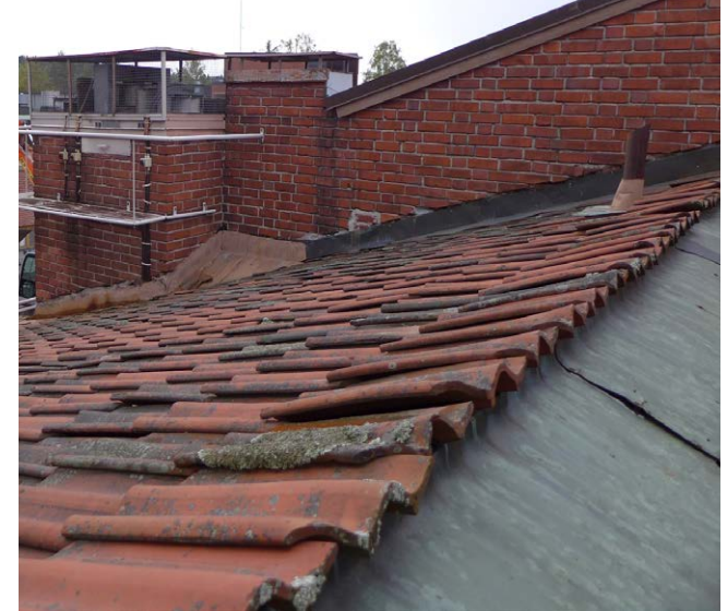
Sosiaalitilojen yläpuolinen kate, pellitykset ja hormin rakenteet. Osa pellityksistä on toteutettu muulla materiaalilla.
