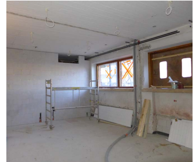
Vanhan väliseinän paikka nähtävillä katossa ja seinässä ja uusi väliseinä inva-WC:n puolella.
