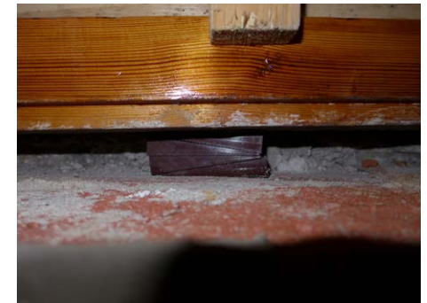
Oikealla: keittiön lounaanpuoleisten ikkunoiden karmit olivat pahoin vaurioituneet.
