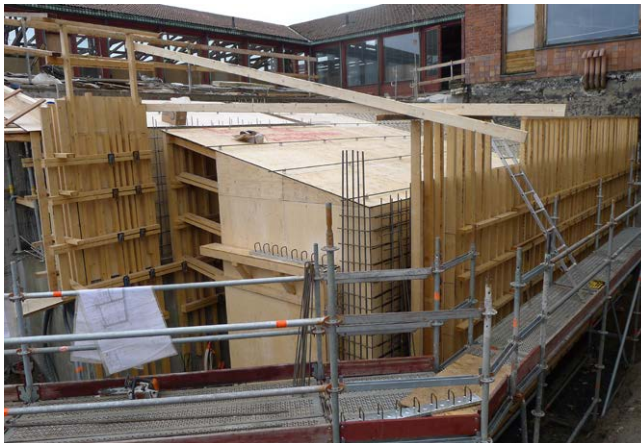
Uuden maanalaisen poistoilmakonehuoneen seinärakenteiden valumuottien rakentaminen. Konehuone jäi näkymättömiin maan alle ja kulku sinne on rakennuksen keittiöstä.
