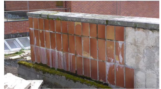
Terassin vanhan muurin laatoitukset olivat huonokuntoiset ja vesirännissä vesi jäi seisomaan.
