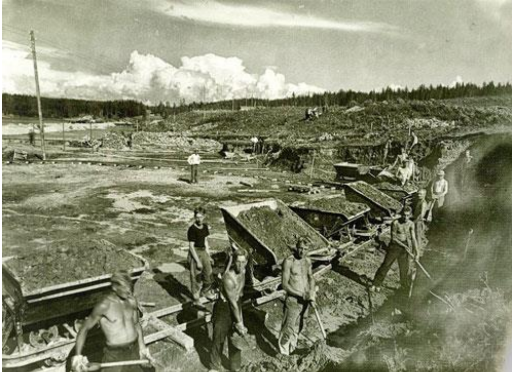
Kuva: Kaukopään sellutehtaan rakennustyöt alkoivat kesällä 1934 Kaukopään lahden maankaivu- ja täyttötöillä. Tehtaan maankaivu tapahtui suurelta osin miesvoimin. Kaukopään tehtaat 80-vuotta, ELKA.
