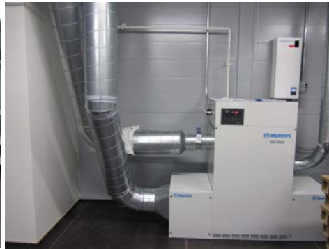
Kuva 5.3. Ilmankuivain tilassa A2 033.
