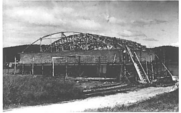
Kuva 4. Karhumäen lentohallia rakennetaan Keljonlahden rantaan. Tiilirakennuksen kaareva kattorakenne on puusta. Ti 28, VKA.
