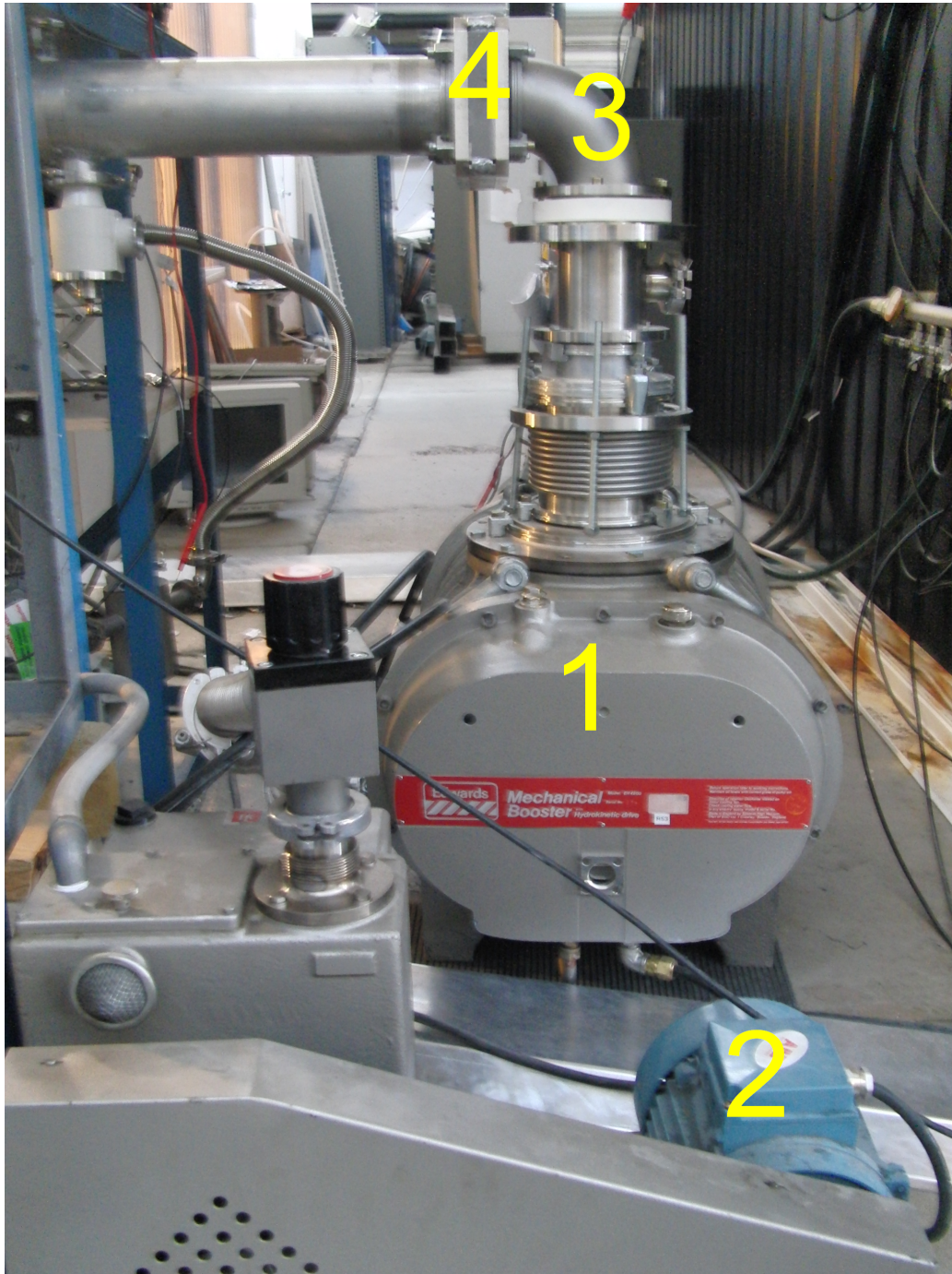
Kuva 3.6: Ionilähdekammion pumppausjärjestelmä: 1) roots-pumppu, 2) roots-pumpun esipumppu, 3) pumppauskanava ja 4) pumppauskanavan venttiili.
