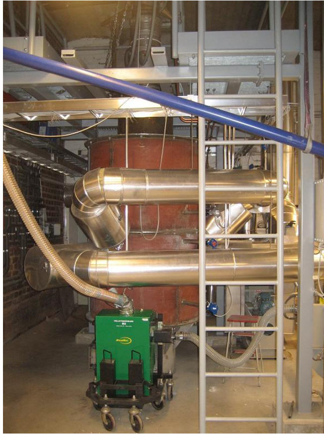
Kuva 3.2: Valokuva Jyväskylän yliopiston mikro-CHP-laitteiston tulipesästä polttimen suunnasta otettuna. Kuvan yläosassa näkyy huoltotasolla sijaitsevia komponentteja sekä stirlingmoottorin asennuskiskot.
