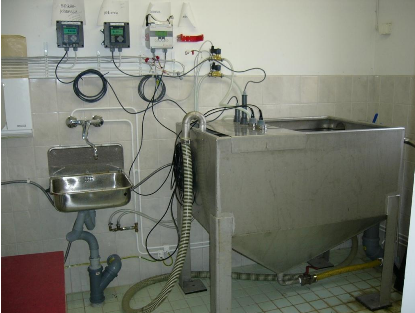
Kuva 3. Malkakosken automaattisen mitta-aseman allas ja laitteistoa.
